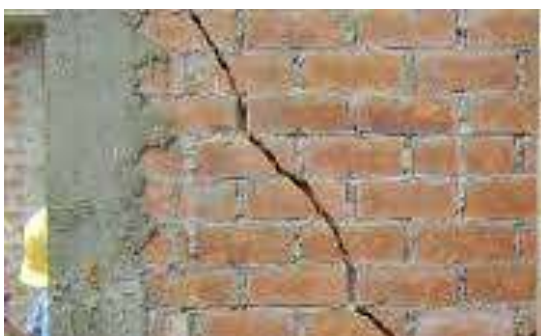
Figura 1. Falla por corte en muro de mampostería.
