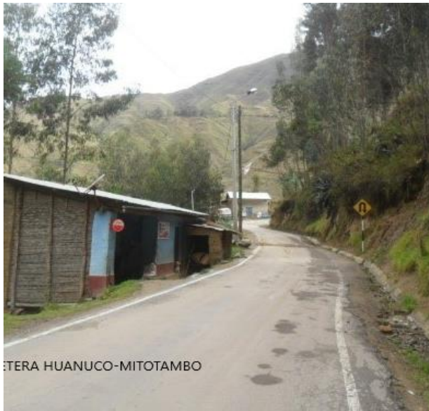
Figura 2. Asfalto con deformaciones
