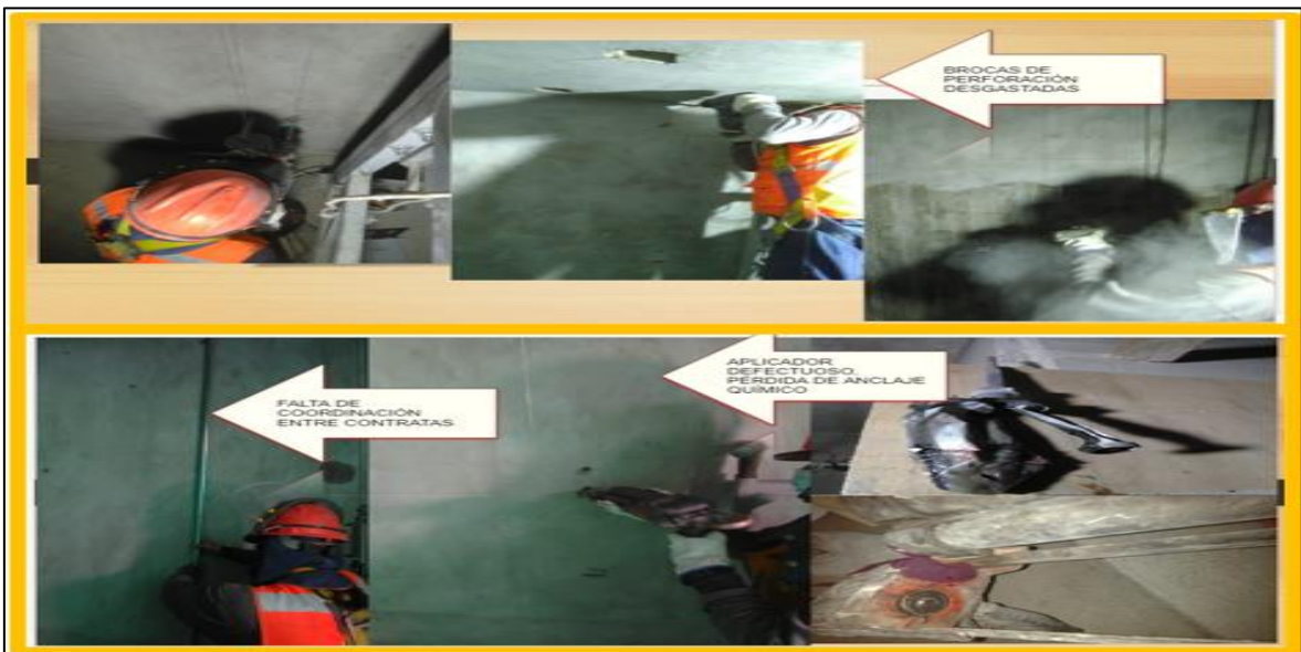
Anexo 26. Fallas detectdas 2
