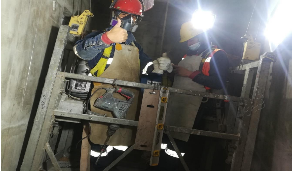
Anexo 31. Equipos y herramientas en su posición designada
