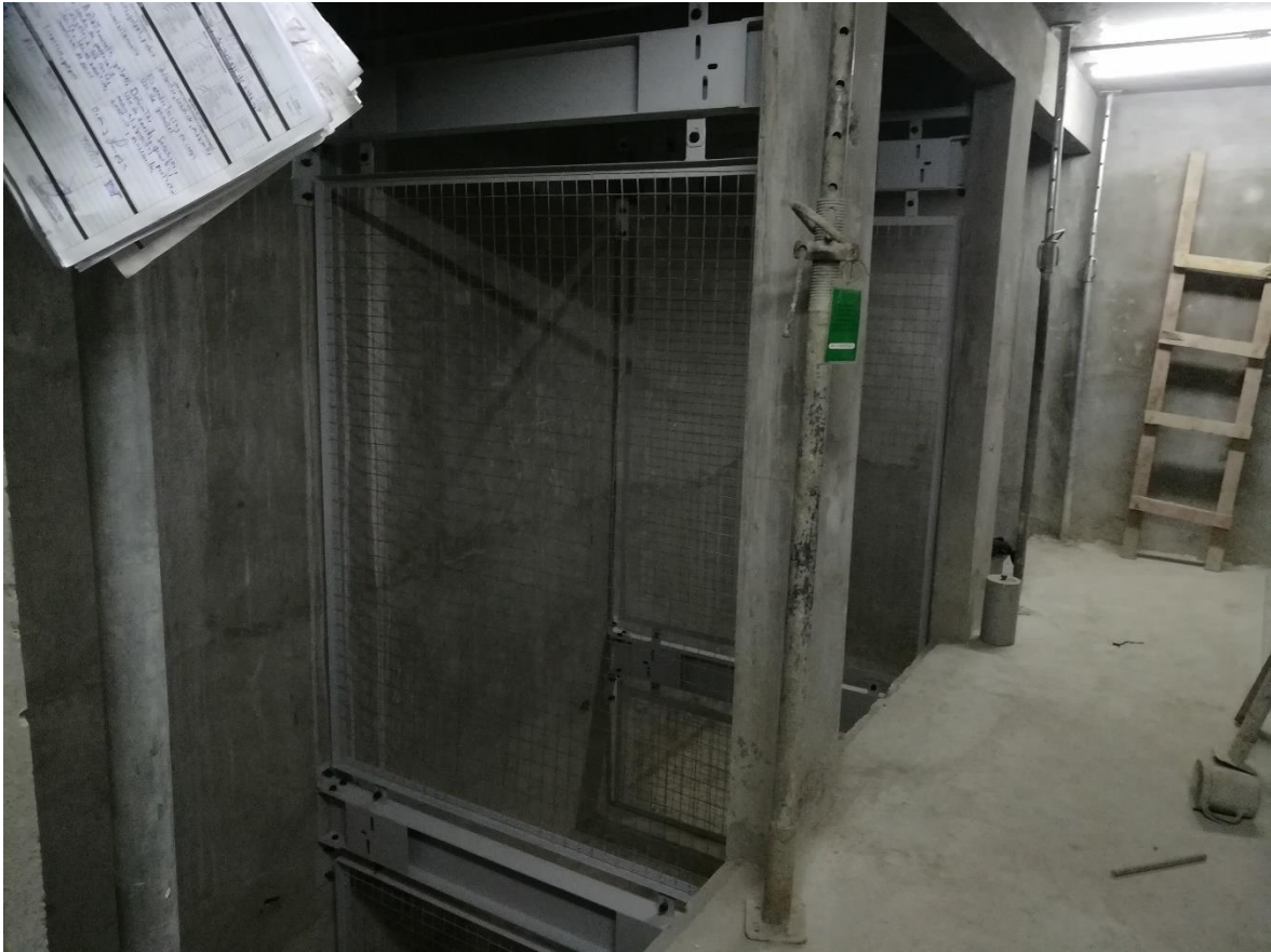
Figura 40. Vista de mallas de seguridad
