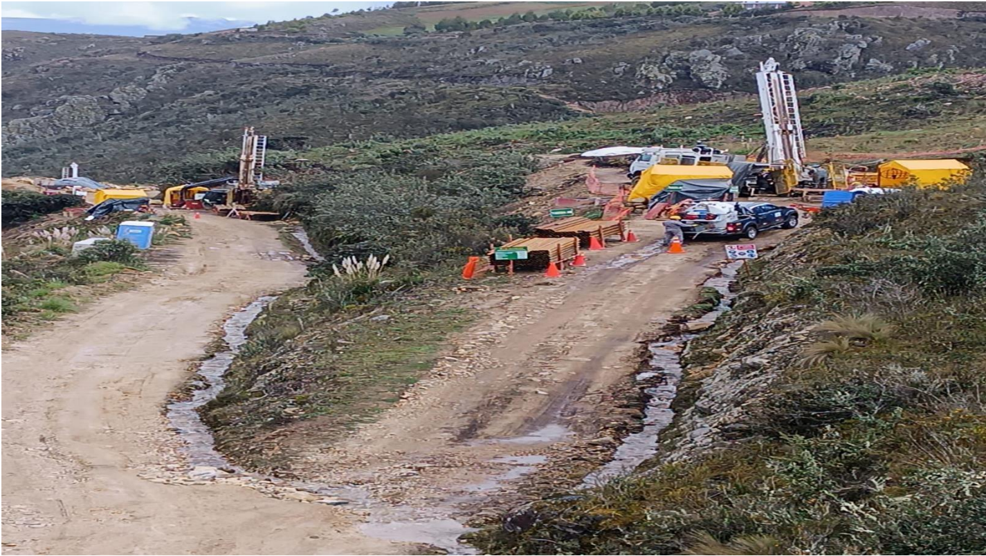
Ilustración 15 Inadecuada distribución - Proyecto Mavila
