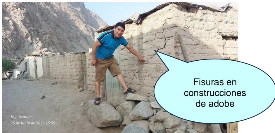
Figura 1 Problemática de edificación de barro sin fibras
