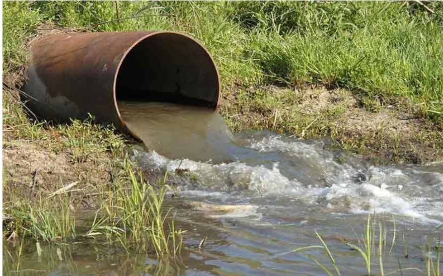
Figura 1: Aguas residuales domésticas.
