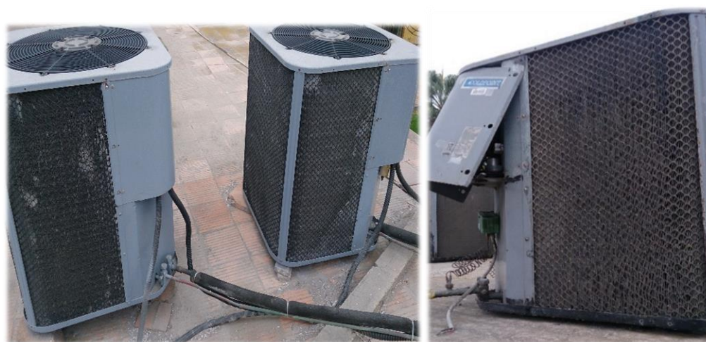
Figura 11: Equipos de aire acondicionado sin mantenimiento preventivo Fuente: MNAAHP
