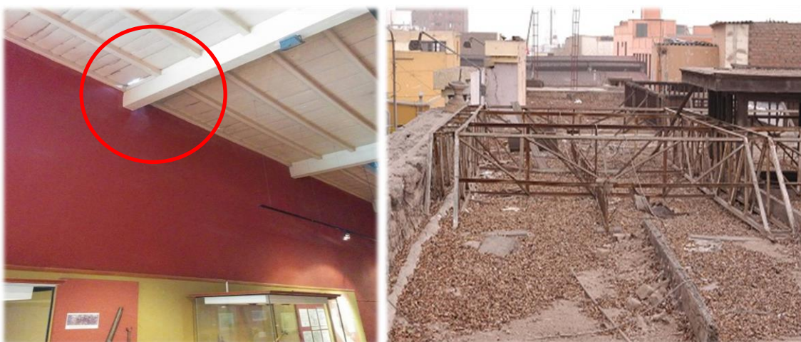
Figura 15: Falta de mantenimiento de los techos. Fuente: MNAAHP
