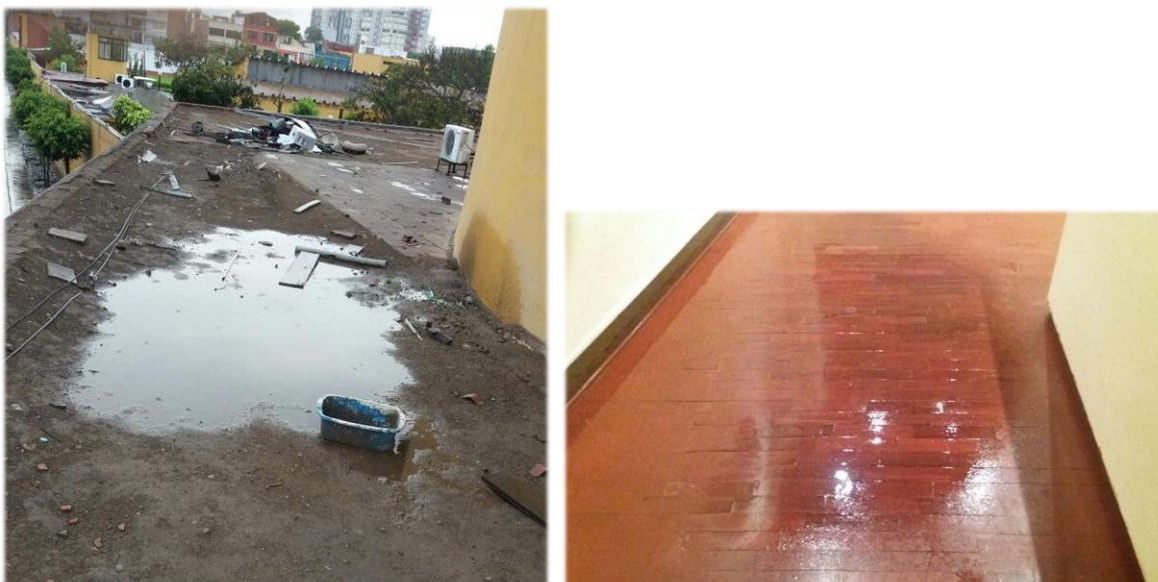
Figura 17: Afectación a la infraestructura por falta de mantenimiento en los techos Fuente: MNAHP
