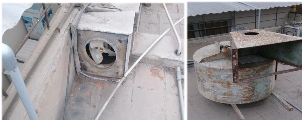
Figura 13: Equipos inoperativos (extractores de aire) Fuente: MNAHP
