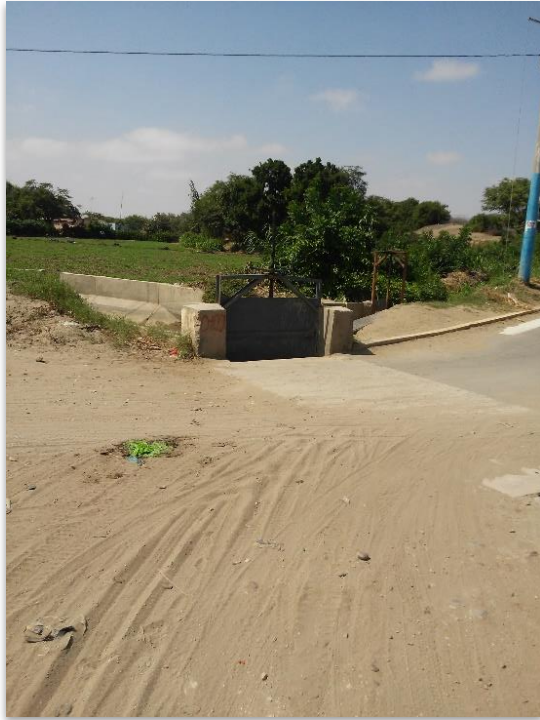
EN LA VISTA SE APRECIA OBRA DE ARTE EN EL KILÓMETRO 0+480 EN EL TRAMO LA ESPERANZA
