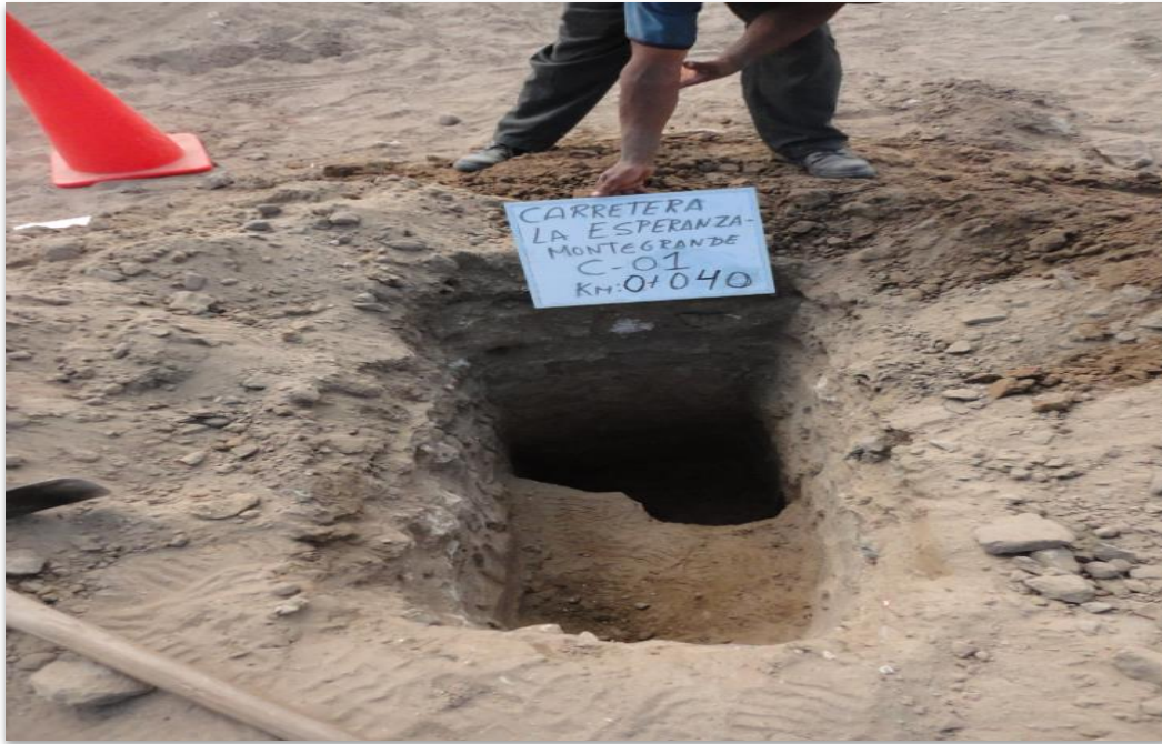
EN LA VISTA SE APRECIA PERSONAL CONTRATADO PARA REALIZACION DE CALICATA Y EXTRACCION DE MUESTRAS- CALICATA 01- Km 0+040
