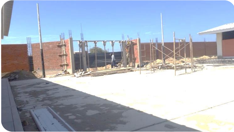
Foto 07: Operario en trabajo Productivo en encofrado de viga y ayudante en trabajo No Contributivo.
