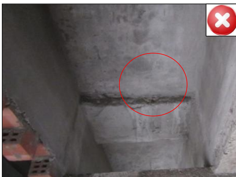
Fig. N° 16: Ductos sin protección
