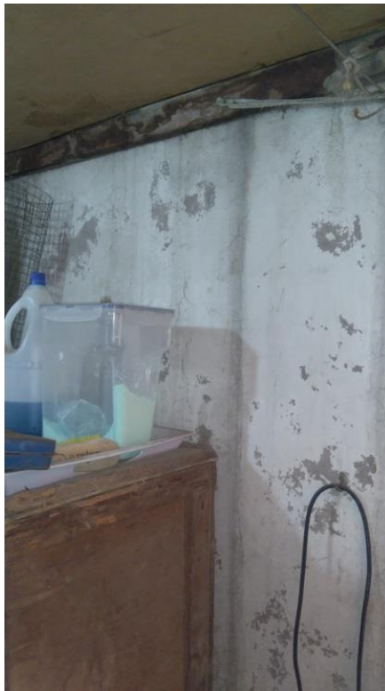
Figura 7 Lesión directa. Humedad por condensación
