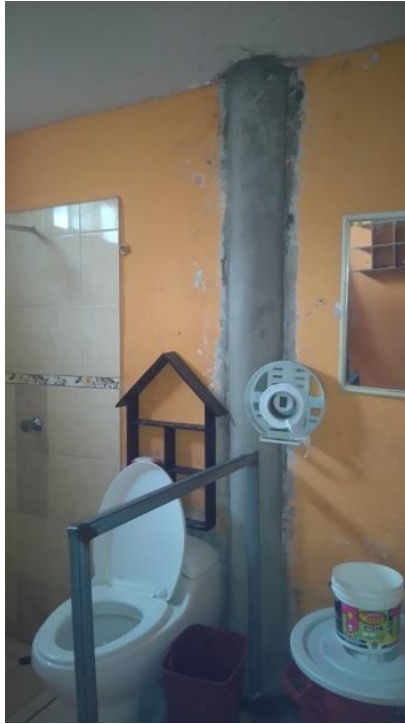
Figura 10 Lesión indirecta. Error de ejecución. Elementos sanitarios embebidos en las estructuras
