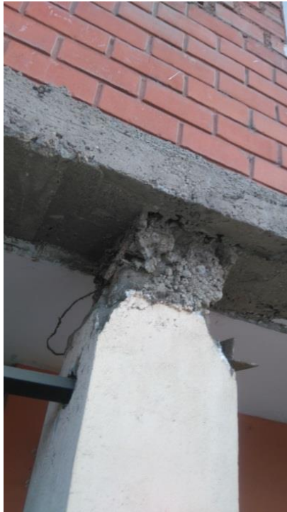
Figura 11 Lesión indirecta. Errores: Ejecución, material, mantenimiento
