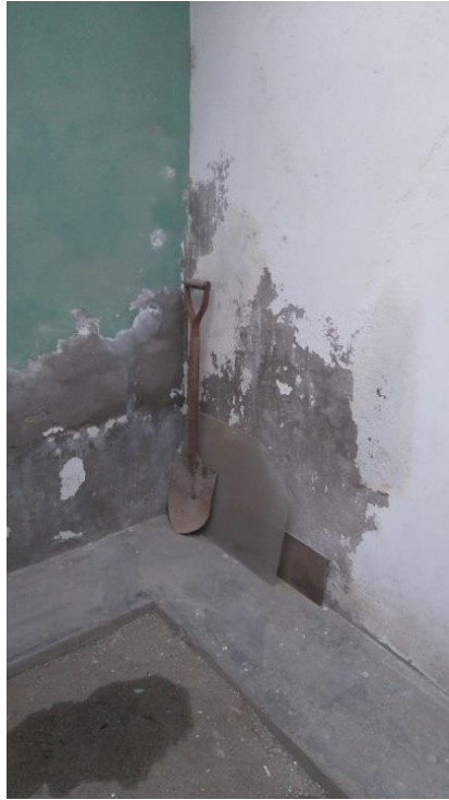
Figura 6 Lesion directa. Humedad por filtracion
