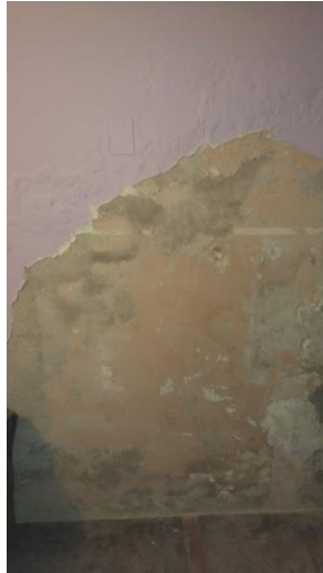
Figura 8 Lesión directa. Por humedad accidental
