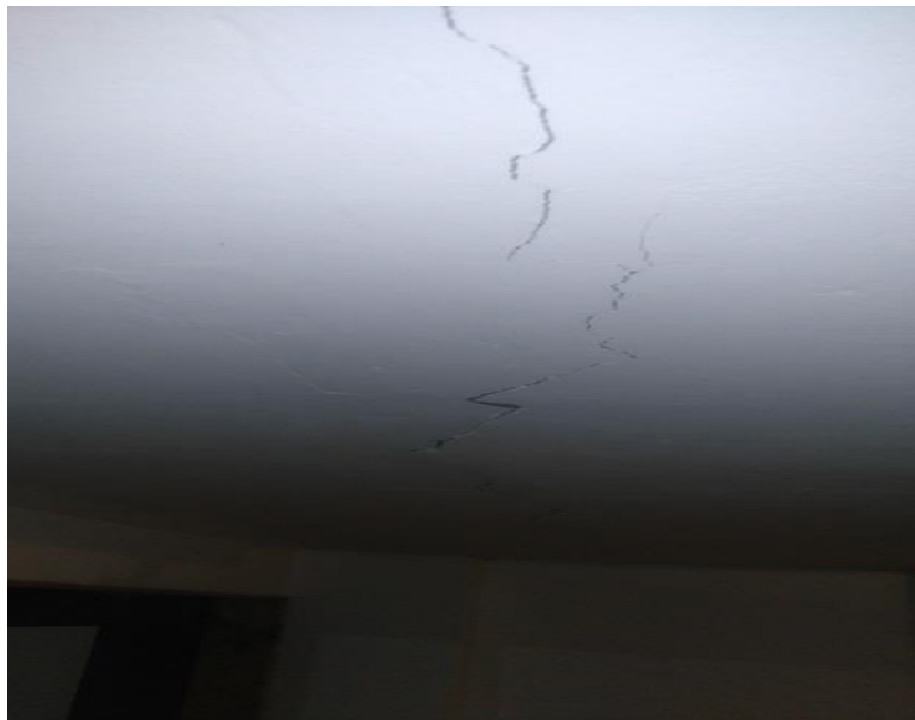
Figura 5 Lesión directa. Losa 1 soporta el peso de losa 2 apoyada fisuras
