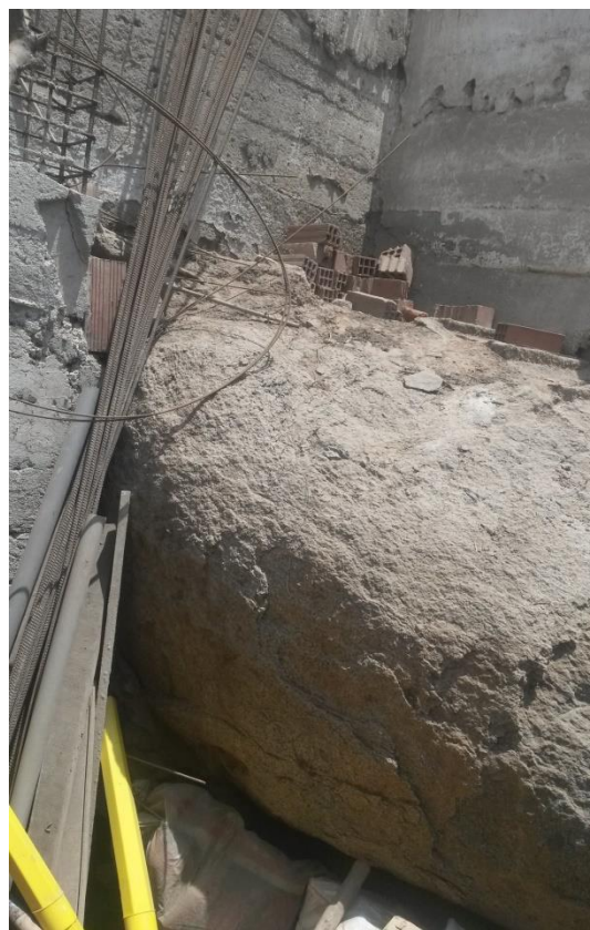
FOTO 4: Paralizaciones de construcciones por presencias de rocas.
