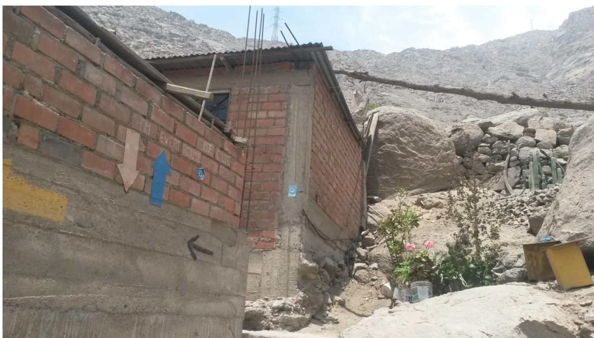
FOTO 5: Viviendas rodeadas de rocas que son un riesgo frente a un fenómeno natural
