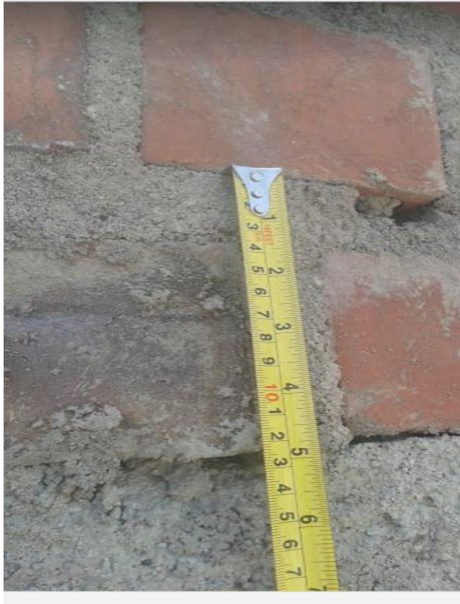
Figura: 3. 32: En la figura se nota la deficiencia en la junta de albañilería
