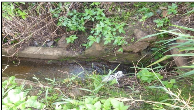
Cunetas en mal estado Fuente: Propia
