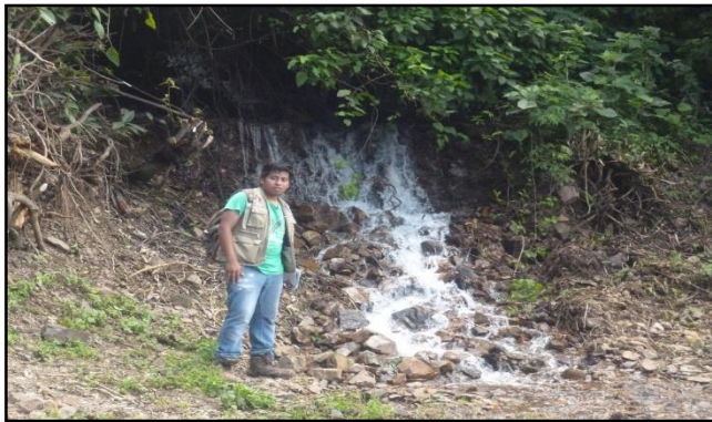
Falta de alcantarillas en la vía Fuente: Propia
