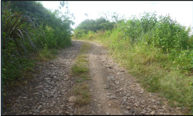
Presencia de vegetación en la vía Fuente: Propia
