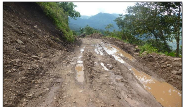
Tramo de carretera con charcos de agua Fuente: Propia
