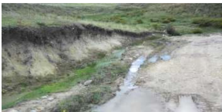
Ilustración 9. Problema de deterioro de carretera por inexistencia de cunetas.
