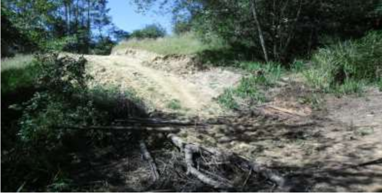
Ilustración 11. Obras de arte rústicos y en mal estado (puente).
