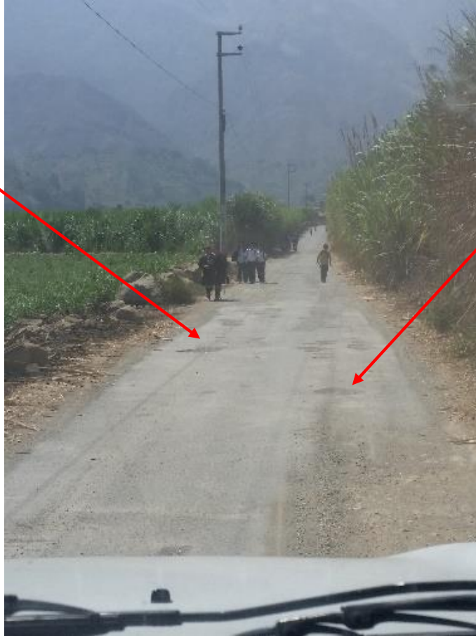
Tramo de la carretera que no cumple con el ancho mínimo de acuerdo a la dg-2014 y el mal estado de la carretera.
