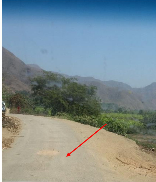
Se observa huecos en el capa asfaltica
