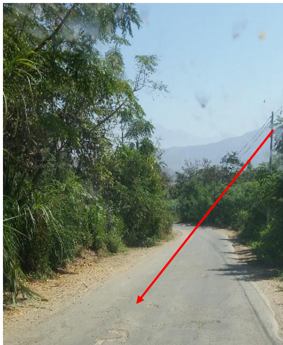
En otro tramo se observa el deterioro de la capa asfaltica
