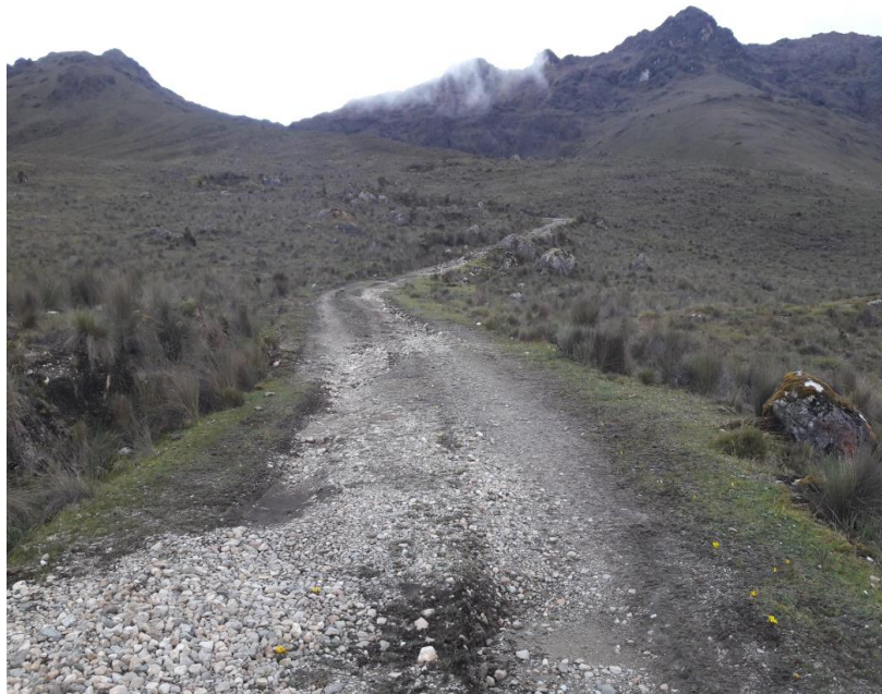
Fig. 7: Estado actual de la carretera, muestra la pendiente pronunciada de esta.
