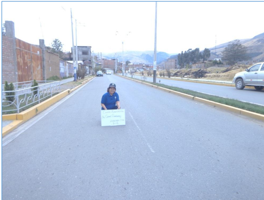
Figura N° 13 Av. Coronel Santibáñez – Huancayo- Junín 2017 –Deficiente Señalización Horizontal
