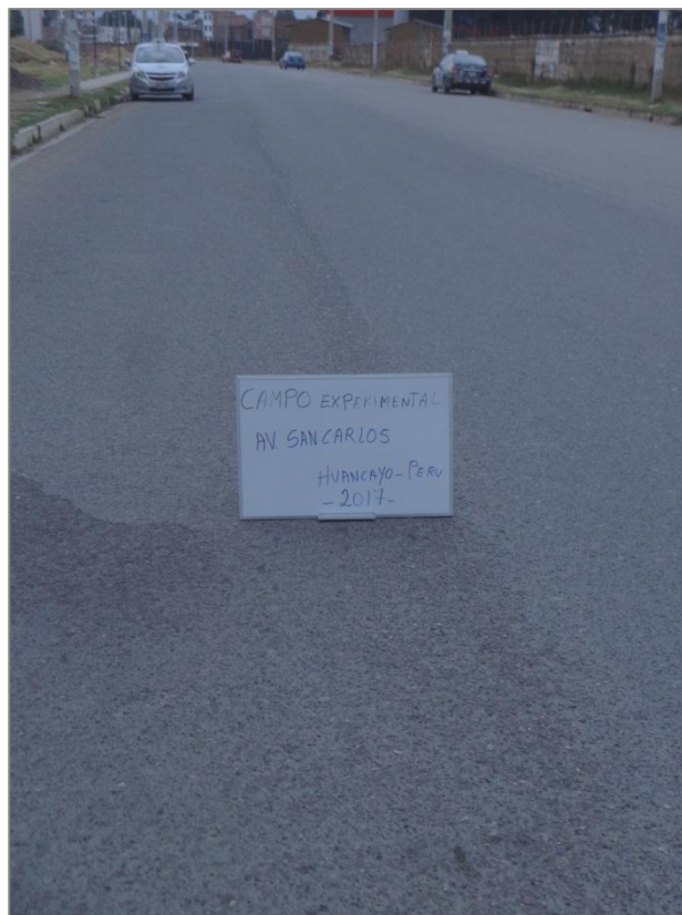
Figura N°10 Av. San Carlo – Huancayo- Junín 2017 –Deficiente Señalización Horizontal
