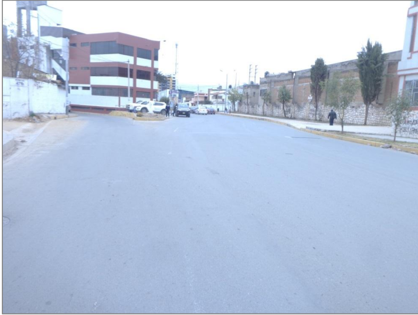
Figura N°11 Av. Centenario – Huancayo- Junín 2017 –Deficiente Señalización Horizontal
