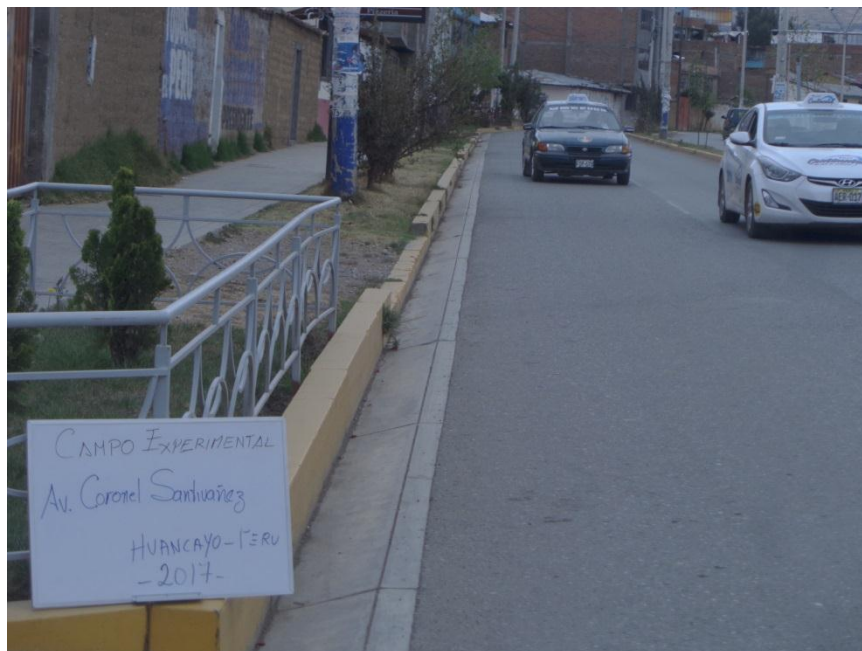
Figura N° 14 Av. Coronel Santibáñez – Huancayo- Junín 2017 –Deficiente Señalización Horizontal
