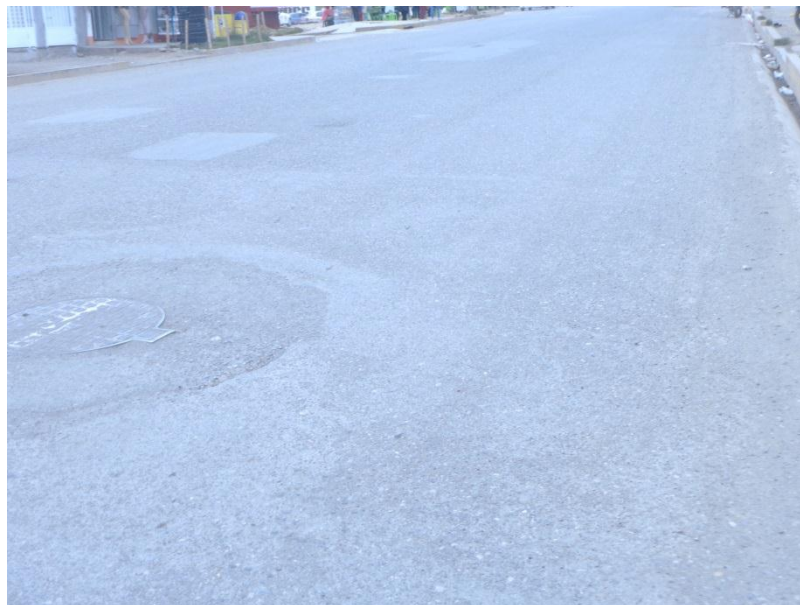
Figura N°16 Av. Callmel del Solar – Huancayo- Junín 2017 –Deficiente Señalización Horizontal
