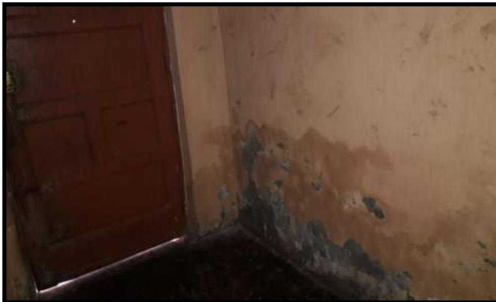
Vista N°5: Se puede apreciar el daño en el acabado y desprendimiento de pintura, en la pared interior de una vivienda.
