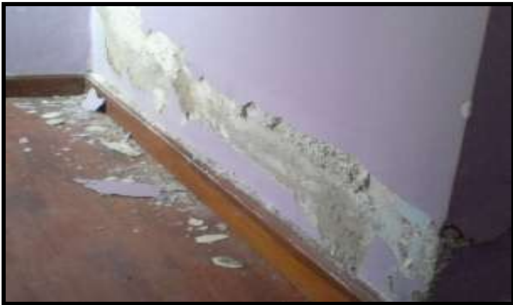
Vista N°7: Se puede apreciar la pared interior de una vivienda en la que se observa el daño en el acabado de desprendimiento, afectando el Tarrajeo y pintura.
