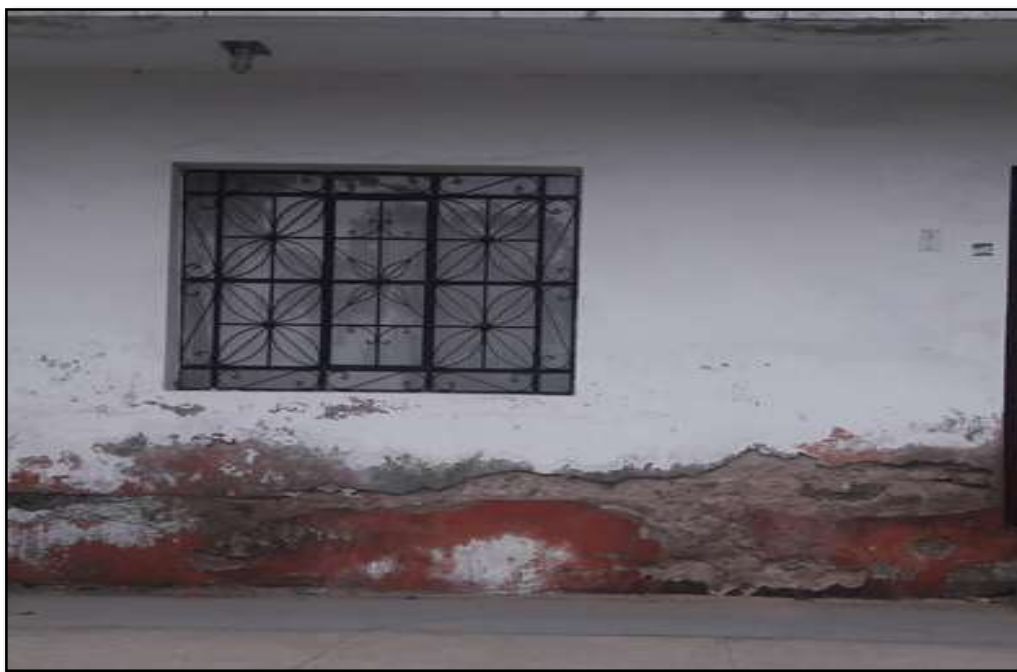
Figura 2: Desintegración del tarrajeo
