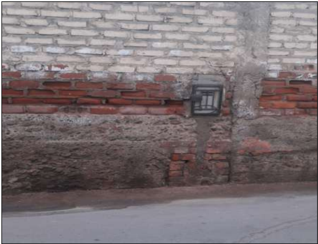
Figura 1: Desintegración del concreto
