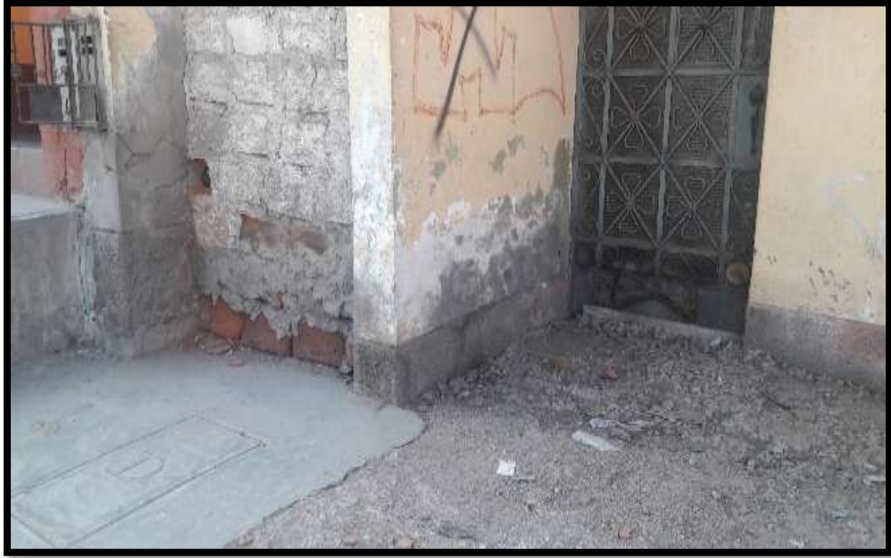
Vista N°6: Se puede apreciar la pared exterior de una vivienda en la que se observa el daño en el acabado, desprendimiento de pintura.
