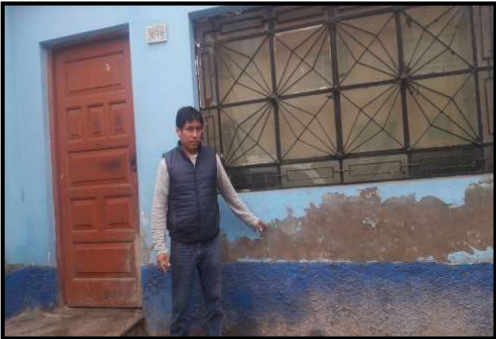
Vista N°2: Se puede apreciar una de las viviendas que presenta descascaramiento de acabados en pared de fachada.
