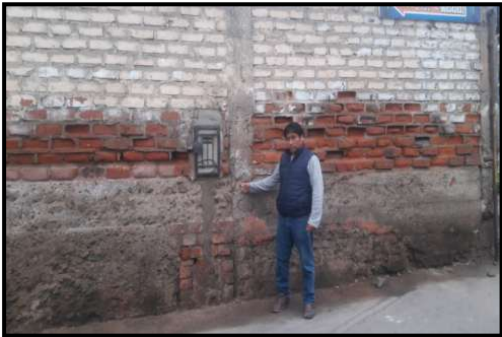
Vista N°3: Se puede apreciar la pared exterior de una vivienda en la que las sales han dañado algunos elementos como son el sobre cimiento, erosión de los ladrillos y la columna que presentan desprendimiento de concreto.
