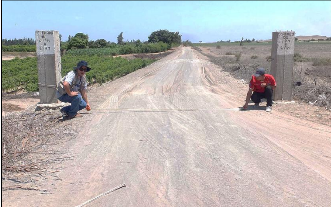
Figura 2. Estado situacional de la vía en estudio.
