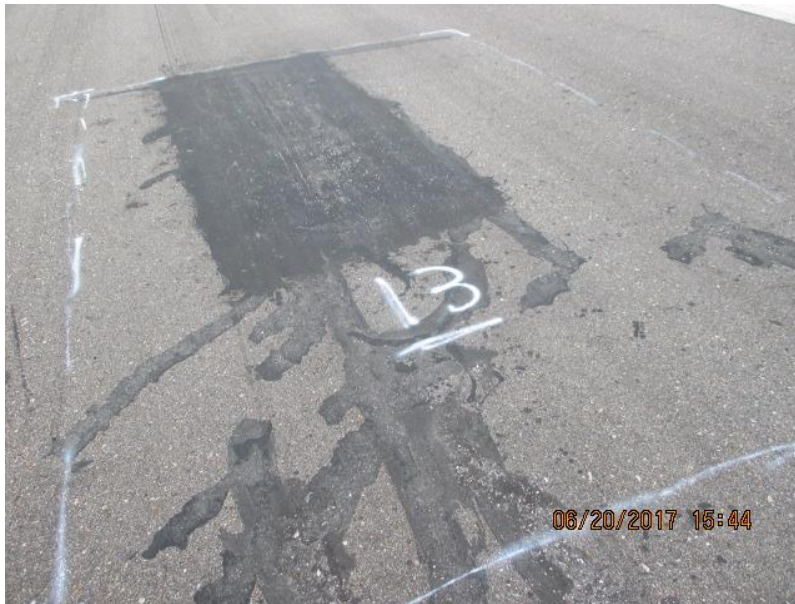
Figura 83. Evaluación de PCI Fuente: Propia
