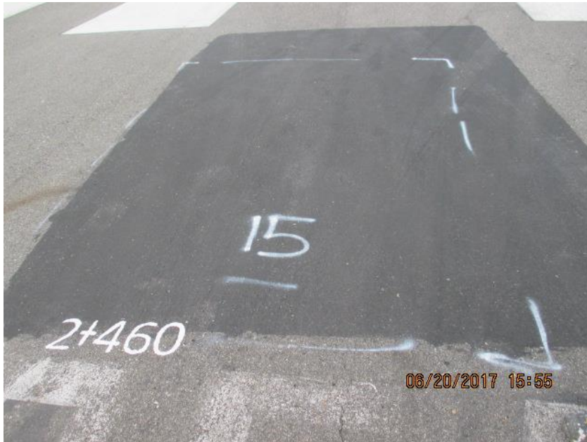
Figura 90. Evaluación de PCI Fuente: Propia
