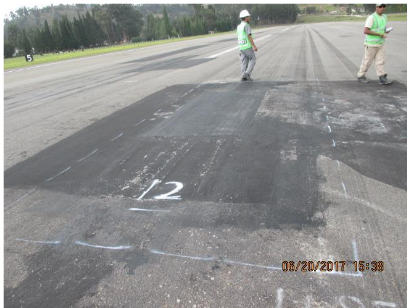
Figura 84 . Evaluación de PCI Fuente: Propia
