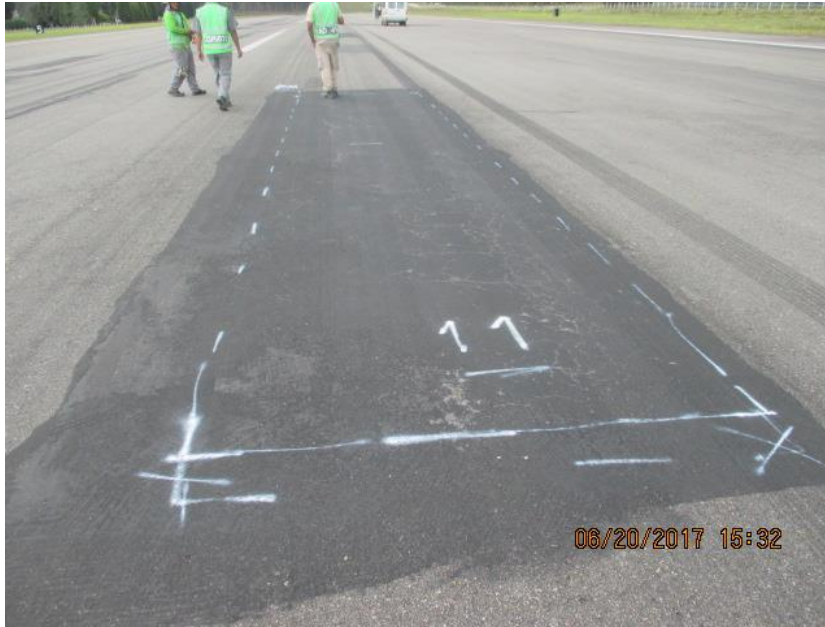
Figura 91. Evaluación de PCI Fuente: Propia
