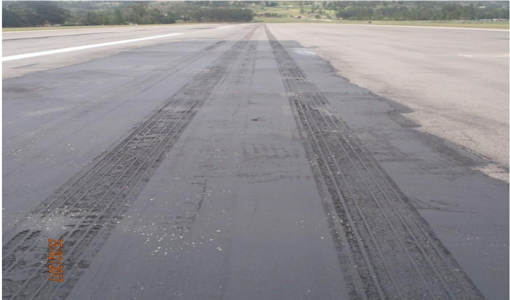
Figura 7. Tratamientos superficiales que afectan a la seguridad operacional. Fuente: Propia
