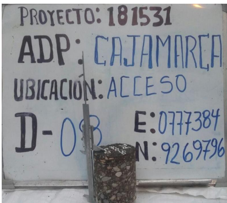
Figura 118.D-08.-Proceso de extracción de núcleo diamantino en la pista de aterrizaje Fuente: EFE – 2015 - AdP
