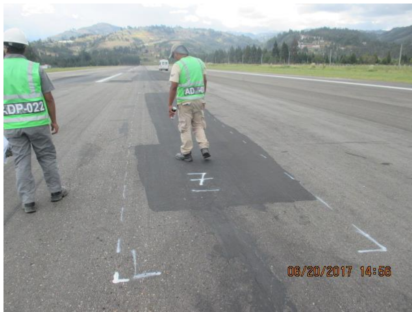
Figura 86. Evaluación de PCI Fuente: Propia
