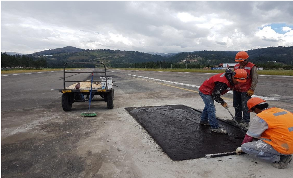
Figura 6. Tratamientos superficiales mal ejecutados y programados Fuente: Propia
