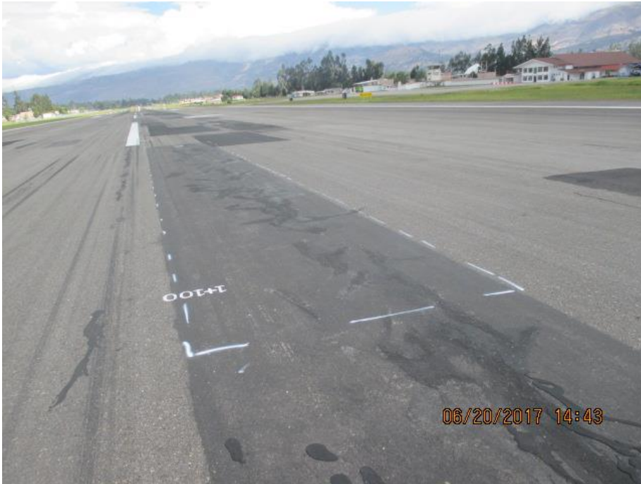
Figura 87. Evaluación de PCI Fuente: Propia
