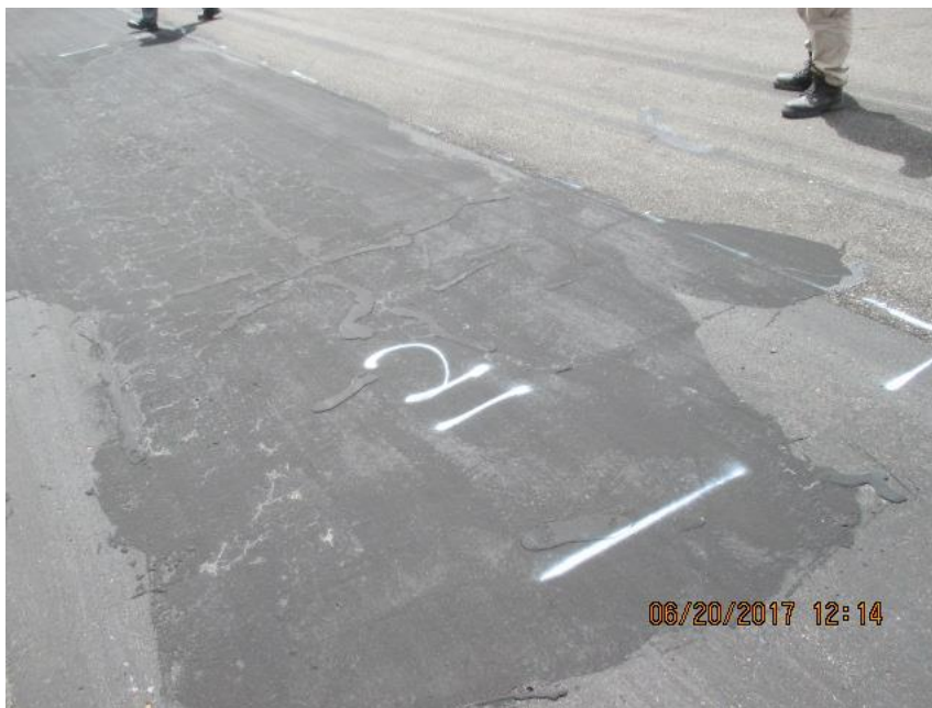
Figura 92. Evaluación de PCI Fuente: Propia
