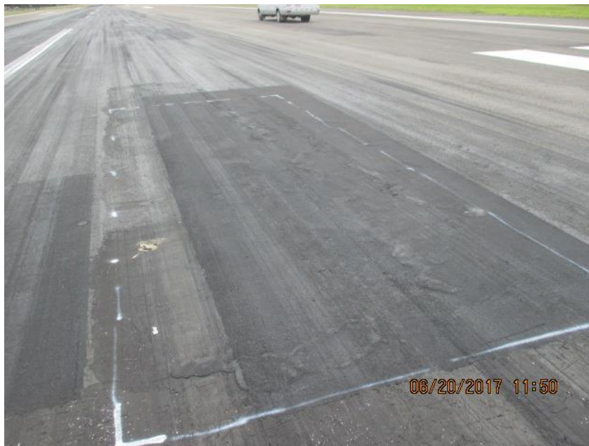
Figura 94. Evaluación de PCI Fuente: Propia
