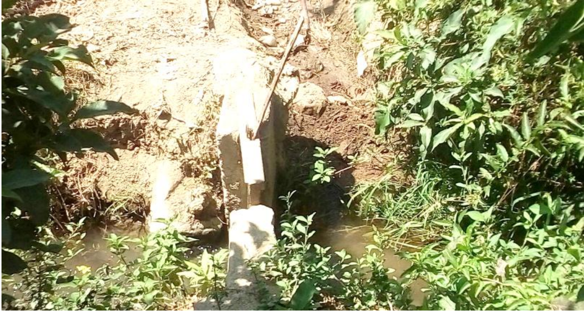
Fotografía N° 07: Compuerta que separa el canal y la parcela de cultivo, esta ayuda a la distribución del agua en los turnos de riego.
