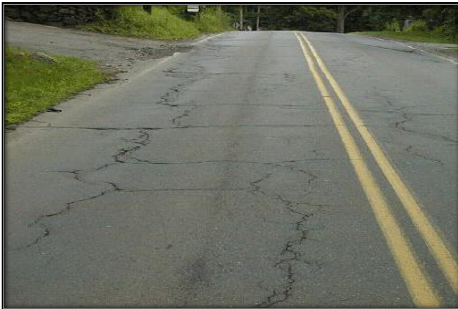
Figura 6. Agrietamiento en bloque. Adaptado de “Cálculo del índice de condición del pavimento flexible”, Por Rodríguez, D., 2009, p. 14, por Universidad de Piura.
