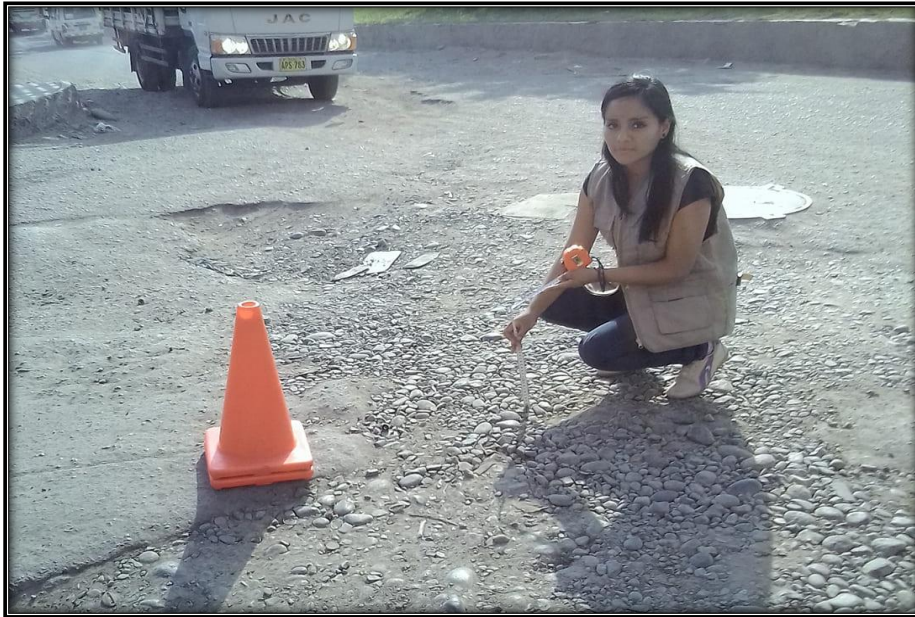
Figura 21. Peladura y desprendimiento. Elaboración propia, 2018.
