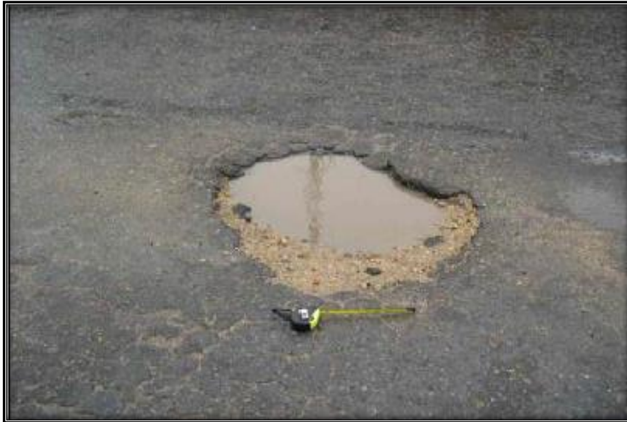
Figura 19. Huecos o baches. Elaboración propia, 2018.
