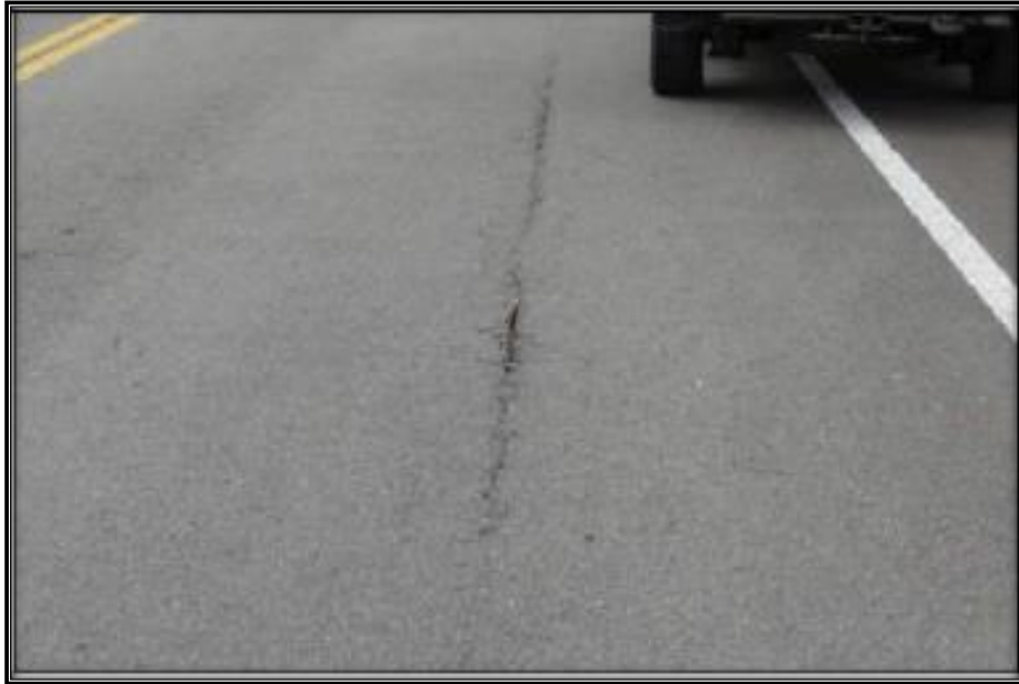
Figura 9. Grietas transversales y longitudinales. Elaboración
