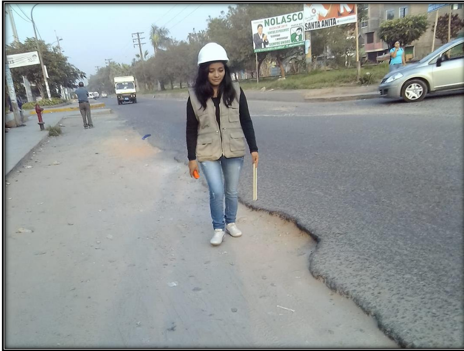
Figura 48. Grietas de borde en la Av. Ferrocarril
