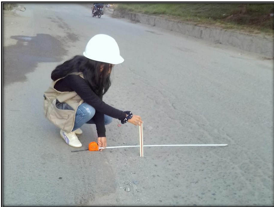
Figura 49. Depresión en la Av. Ferrocarril.
