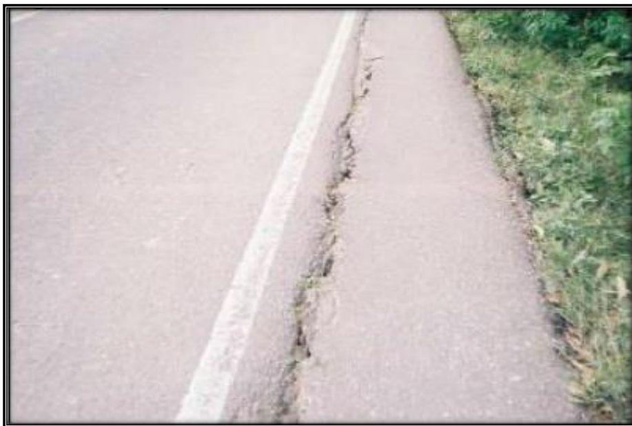
Figura 14. Desnivel carril – berma. Tomado de “Deterioros en pavimentos flexibles y rígidos”, por Miranda, R., 2010, p. 26, por Universidad Austral de Chile.
