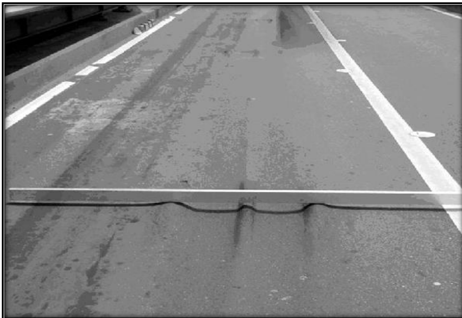
Figura 16. Ahullamiento. Tomado de “Deterioros en pavimentos flexibles y rígidos”, por Miranda, R., 2010, p. 26, por Universidad Austral de Chile.
