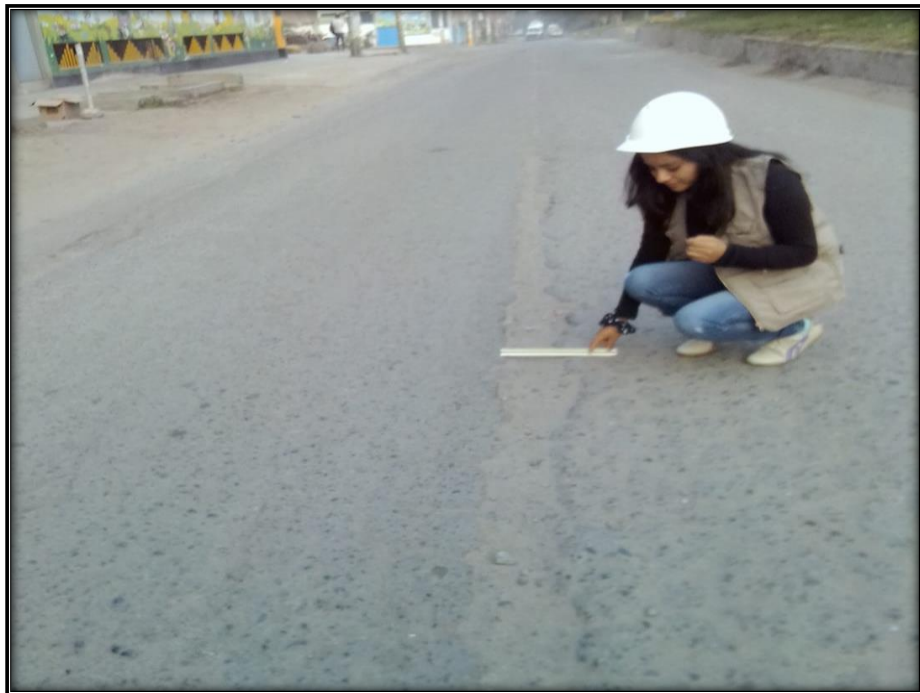
Figura 51. Grietas longitudinales en la Av. Ferrocarril.
