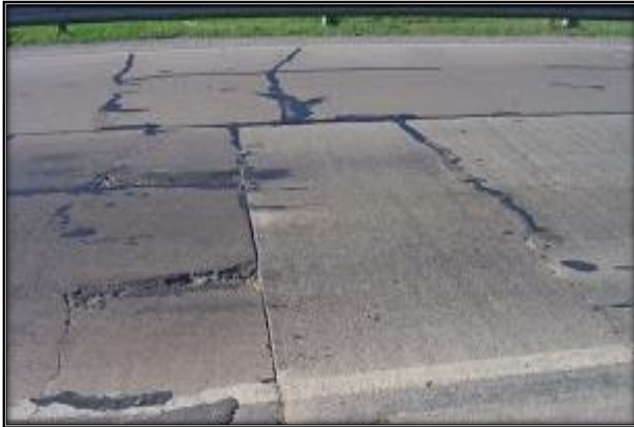
Figura 7. Grieta de reflexión de junta. Elaboración propia, 2018.
