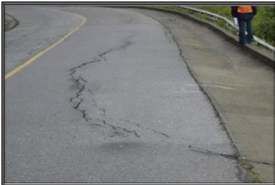
Figura 10. Grietas parabólicas o por deslizamiento. Elaboración propia, 2018.
