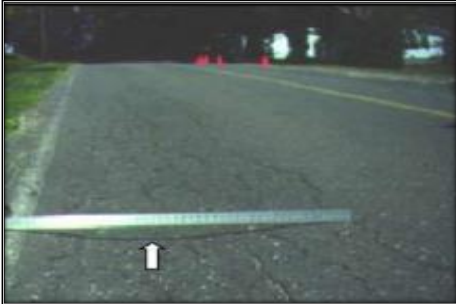
Figura 13. Depresión. Adaptado de “Cálculo del índice de condición del pavimento flexible”, Por Rodríguez, D., 2009, p. 16, por Universidad de Piura.
