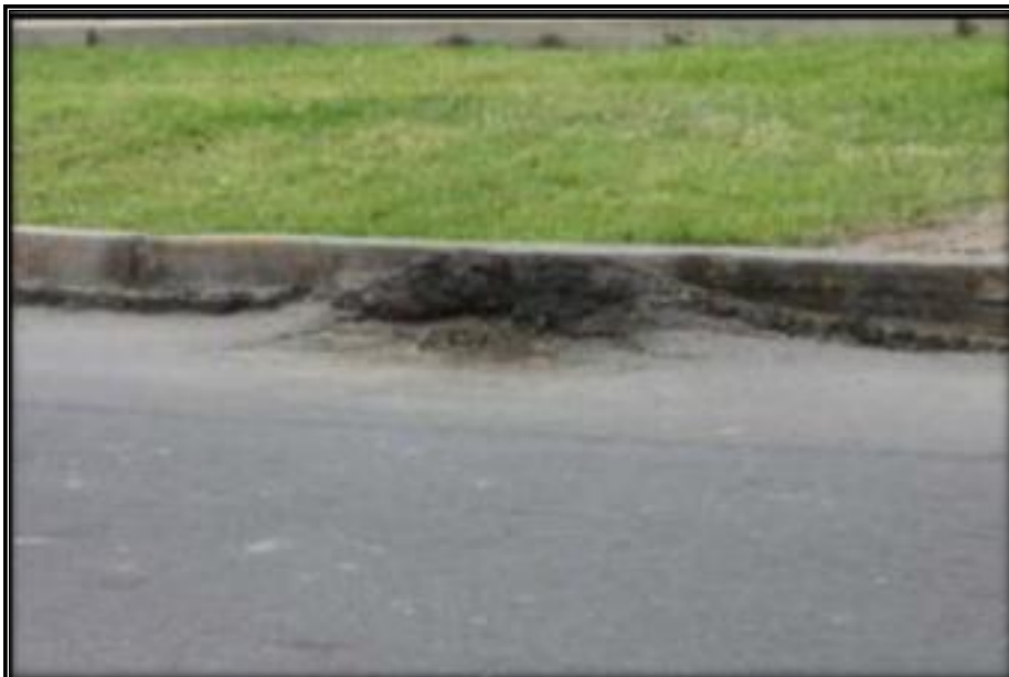
Figura 18. Hinchamiento. Adaptado de “Cálculo del índice de condición del pavimento flexible”, Por Rodríguez, D., 2009, p. 24, por Universidad de Piura.
