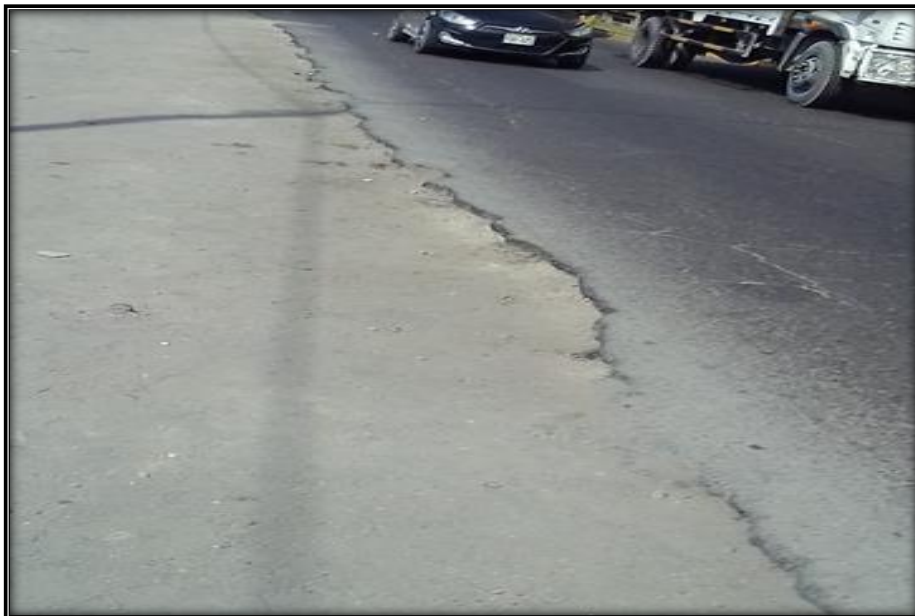
Figura 8. Grieta de borde. Elaboración propia, 2018.
