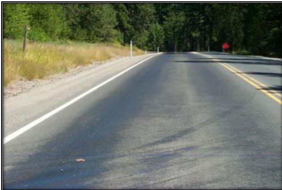
Figura 22. Exudación. Tomado de “Diseño de Pavimentos I Evaluación de Pavimentos”, por Corros, M., Urbáez, E., y Corredor G., 2009, p. 3-9, por Universidad Nacional de Ingeniería.
