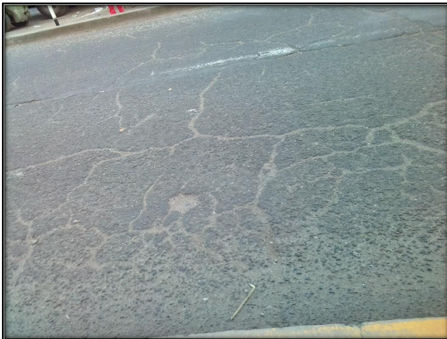
Figura 55. Agrietamiento en bloque en la Av. Ferrocarril.
