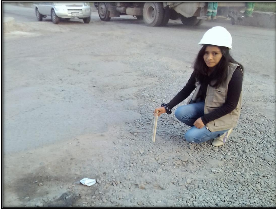
Figura 54. Desprendimiento de agregados en la Av. Ferrocarril.
