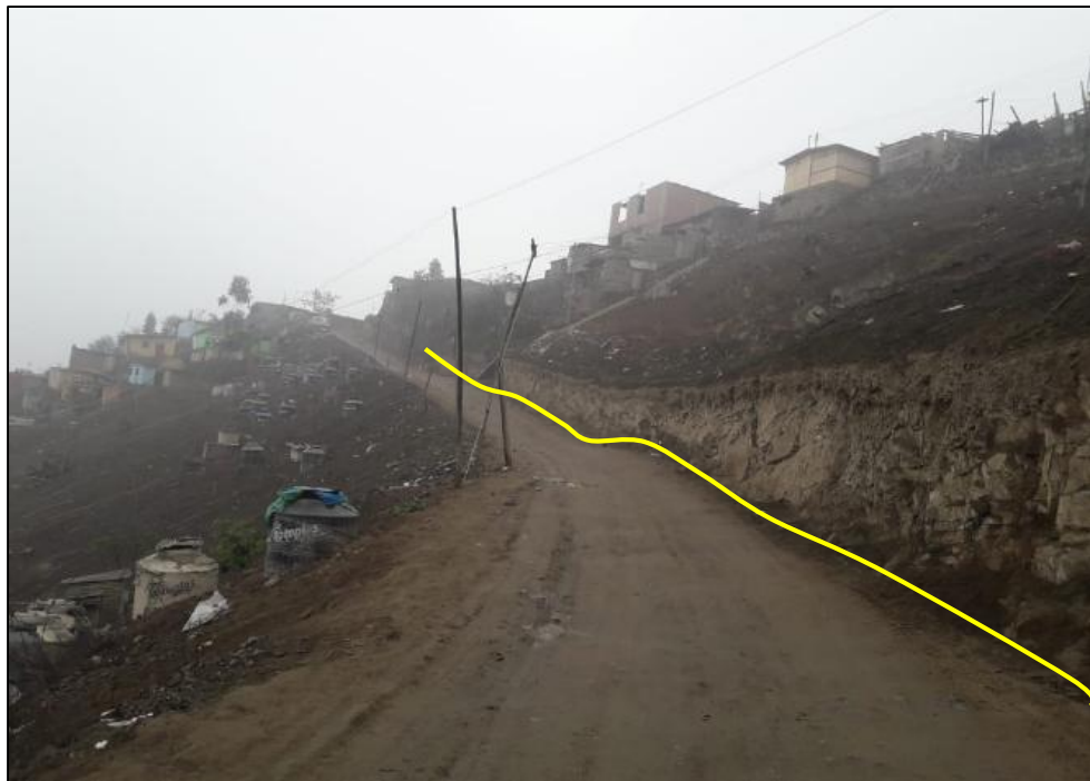
Figura 27: Verificación de Talud Inestable
