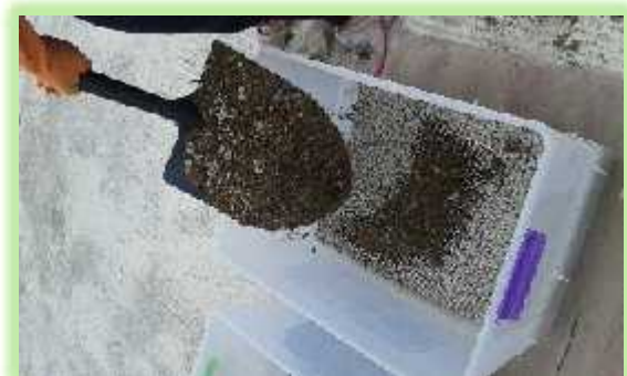
12. Sobre la malla de acero se coloca 10 cm de la mezcla de grava y tierra
