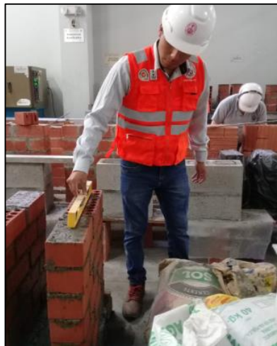
Figura 20: Uso del Nivel de Mano para verificar la Verticalidad y Horizontalidad del Murete
