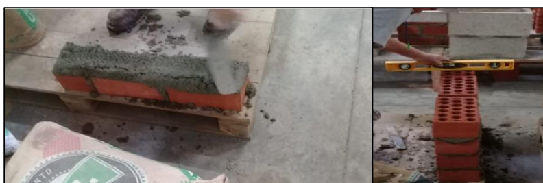
Figura 22: Primera Hilada con el Mortero Embolsado (Izquierda); Uso del nivel de Mano
