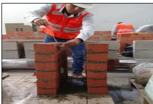
Figura 23: Uso de la Plomada en la Elaboración del Murete con Mortero Embolsado
