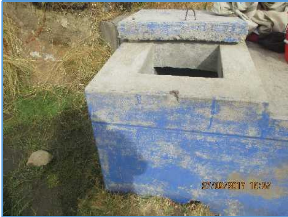
Figura 2.2: Captación La Loma
