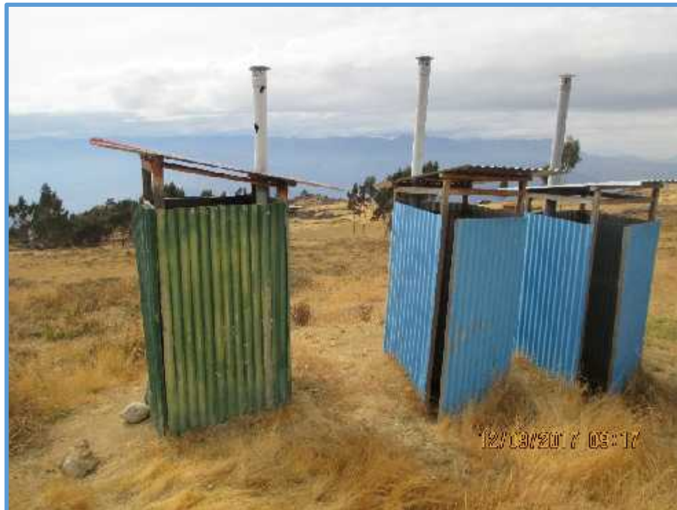
Figura 4: Letrinas tipo hoyo seco en mal estado
