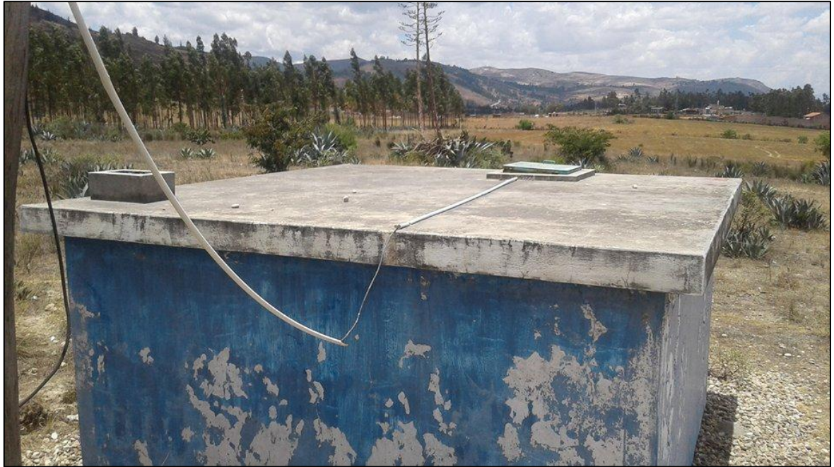
Fotografía 3. Reservorio semi-apoyado de 4m x 3.6m x 2m del sistema de abastecimiento que cuentan, se encuentra en mal estado deteriorado.
