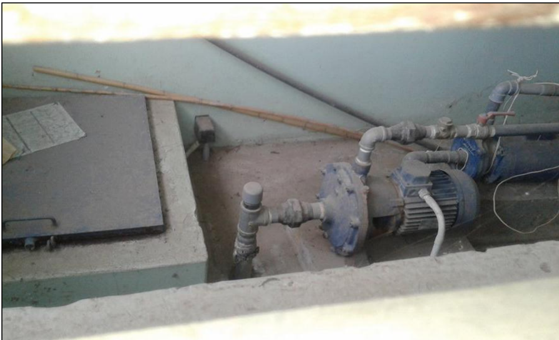
Fotografía 2. Cámara del sistema de bombeo hacia el reservorio.
