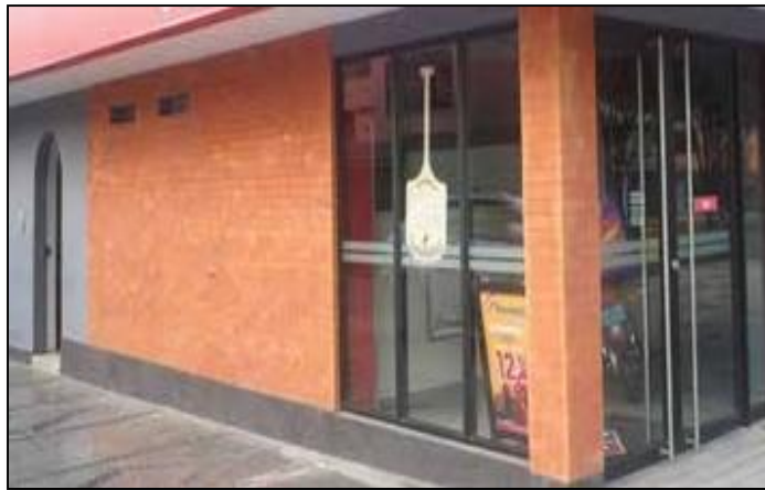
Figura 11. Obra ejecutada con mortero polimérico en la Molina Fuente: página comercial Conte Group s.a.c. (2018) Perú
