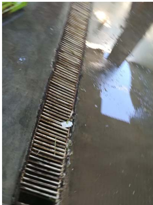
Vías del área de entrada lavaderos con deficiente limpieza REOPA 2018
