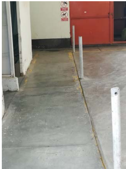
Señalizaciones inadecuadas acceso área de descarga REOPA 2018
