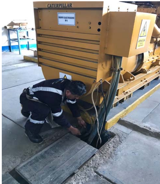
Mantenimiento mecánico con EPP inadecuado
