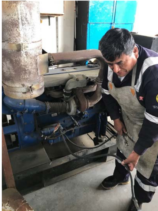
Mantenimiento mecánico con EPP inadecuado
