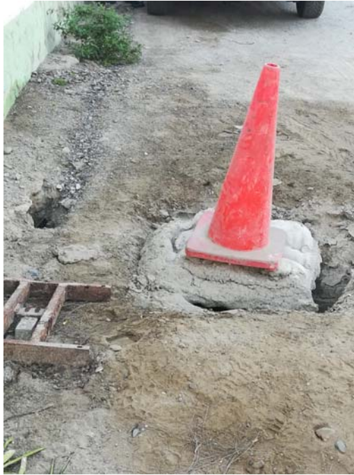
Inadecuada señalización en vías de acceso a planta REOPA 2018
