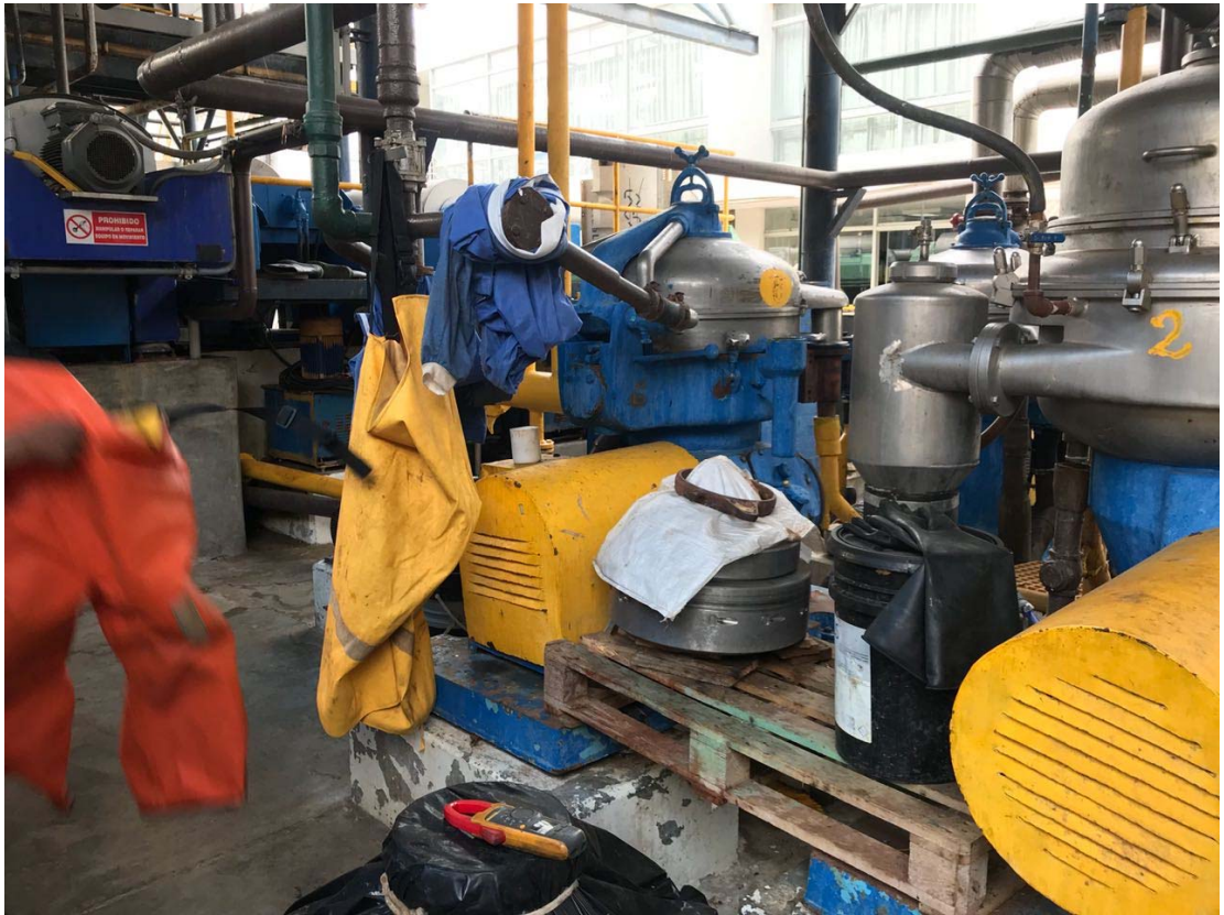
Inadecuadas prácticas de organización área de calderos – REOPA 2018
