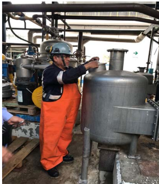
Mantenimiento pintura con EPP inadecuado
