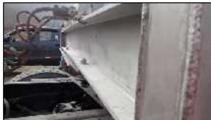
Figura N° 38 – Viga frontal deformada de la estructura de la tolva Fuente: Propia
