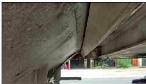
Figura N° 39 – Cara frontal deformada de la tolva Fuente: Propia
