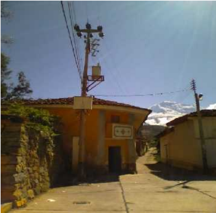
Gráfico (18): Subestación existente en Media Tensión
