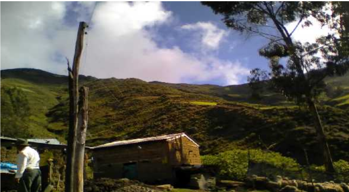
Gráfico (37) Estructuras de poste inadecuadas, en la red eléctrica existente
