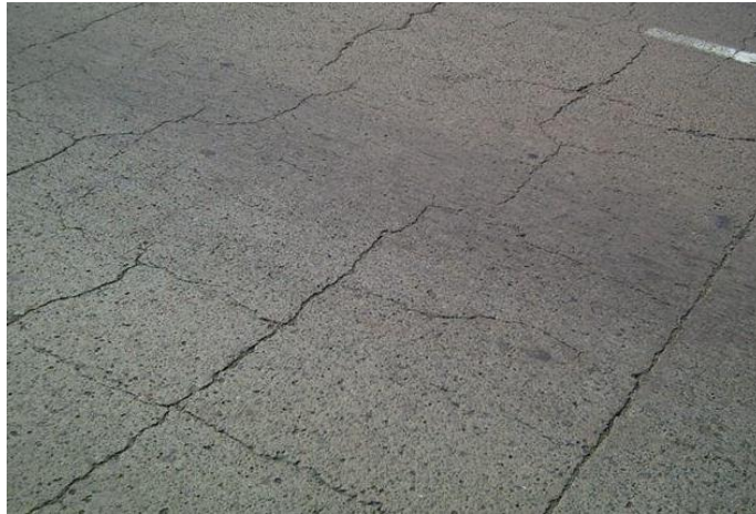
Figura 4. Fisura en losa de concreto
