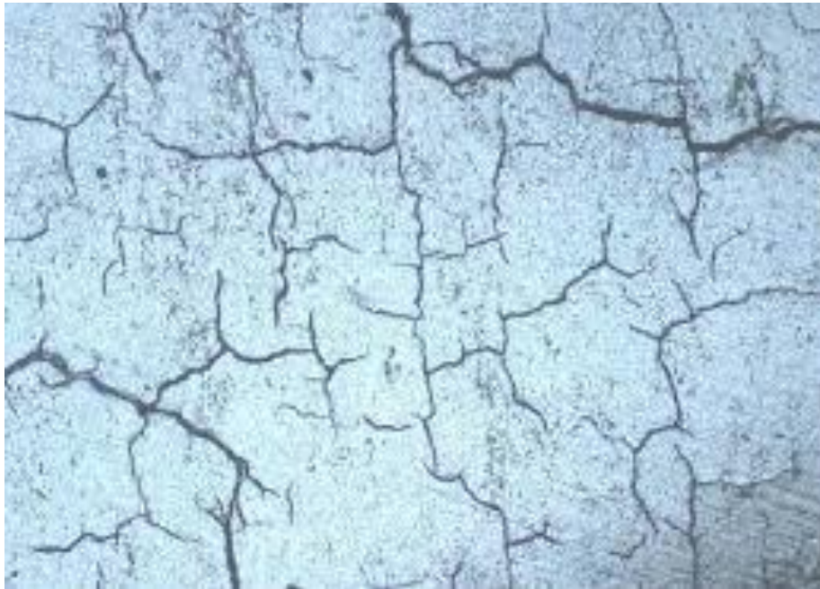
Figura 4. Fisura en toda la losa “piel de cocodrilo”
