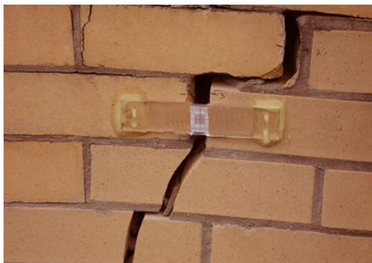
Figura 3. Fisura no estructural
