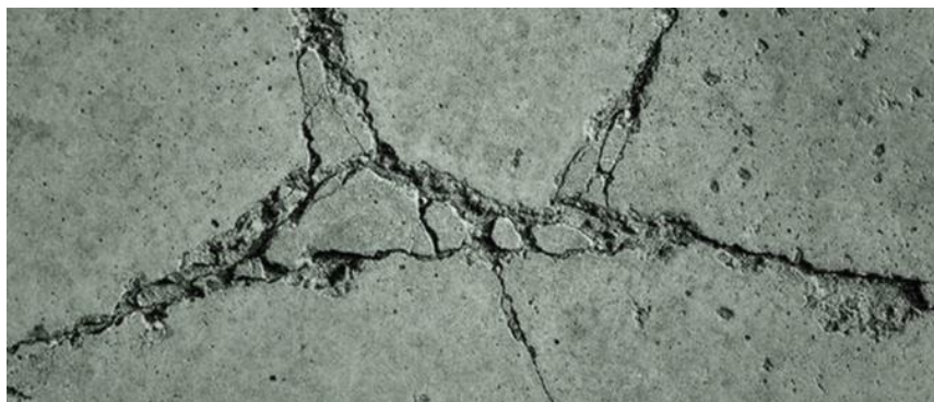
Imagen N° 03: Agrietamientos en las paredes
