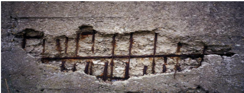
Imagen N° 04. Oxidación del acero
