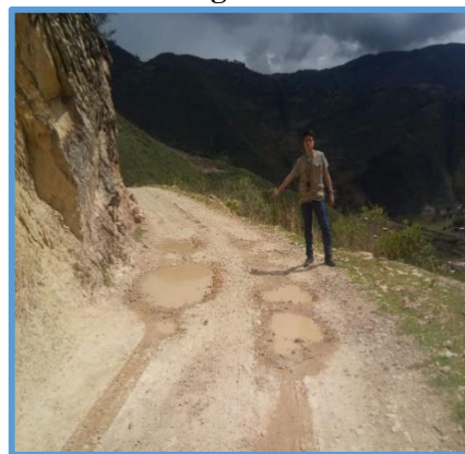
Estado actual de la vía Fuente: Elaboración propia
