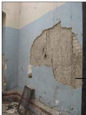
Desprendimiento total del enlucido de yeso por efecto del incendio
