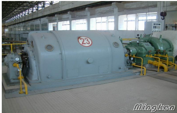
Figura 7. Generador eléctrico acoplado a turbina de vapor.
