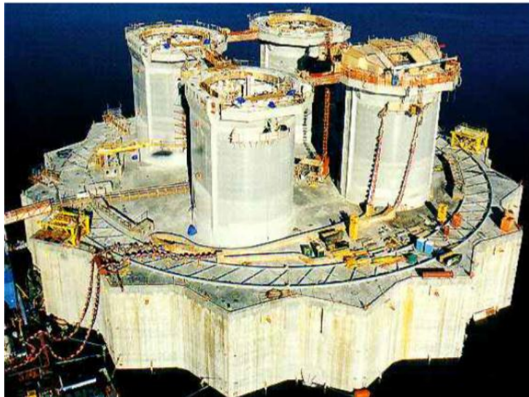
Figura 13. Cimentación de la plataforma Hibernia parcialmente hundida
