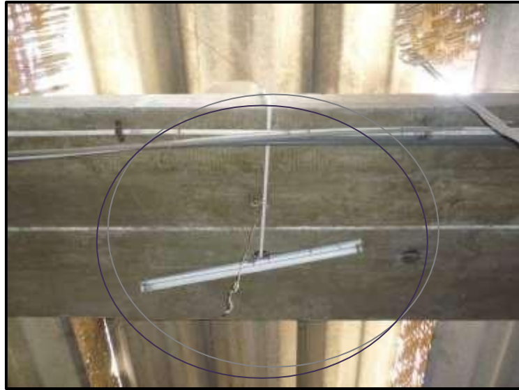
Figura 90: Instalaciones eléctricas expuestas – Fuente propia.
