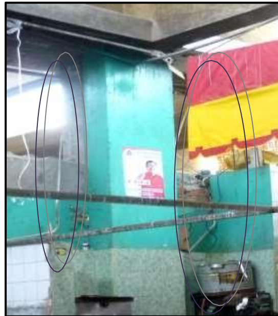
Figura 91: Falta de criterio en las instalaciones de los distintos puestos – Fuente propia
