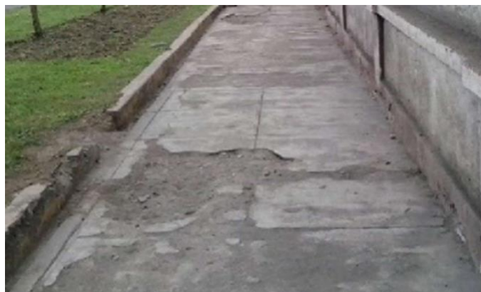
Figura 13. Problemas en las veredas
