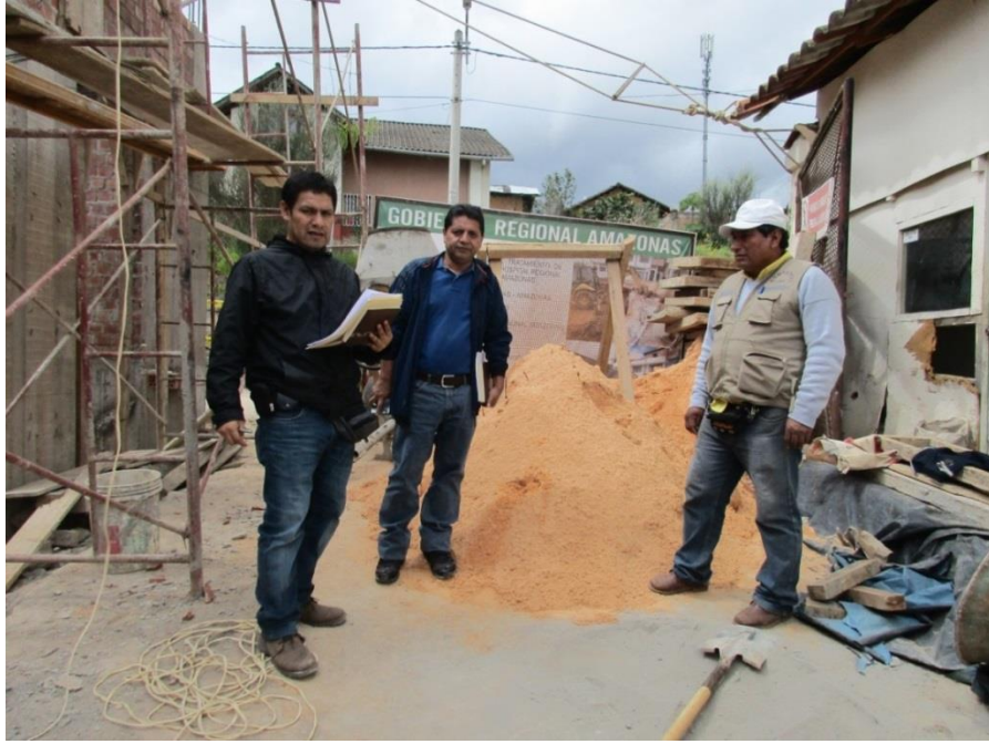
Otra vista de la obra ubicada en el Pasaje Daniel Alcides Carrión, Ciudad de Chachapoyas. Se nota la arena de cantera Cerro Colorado.
