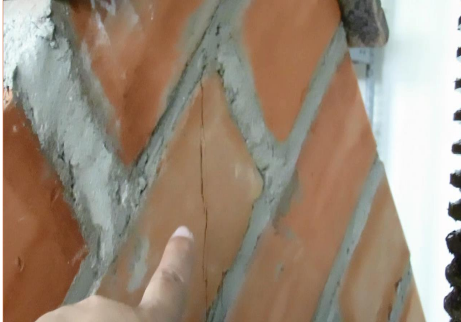
Inicio de falla a compresión diagonal de murete de albañilería N° 02, preparada con mortero cuya arena es de la cantera Rio Utcubamba. La falla se inicia en los ladrillos de la segunda hilada.
