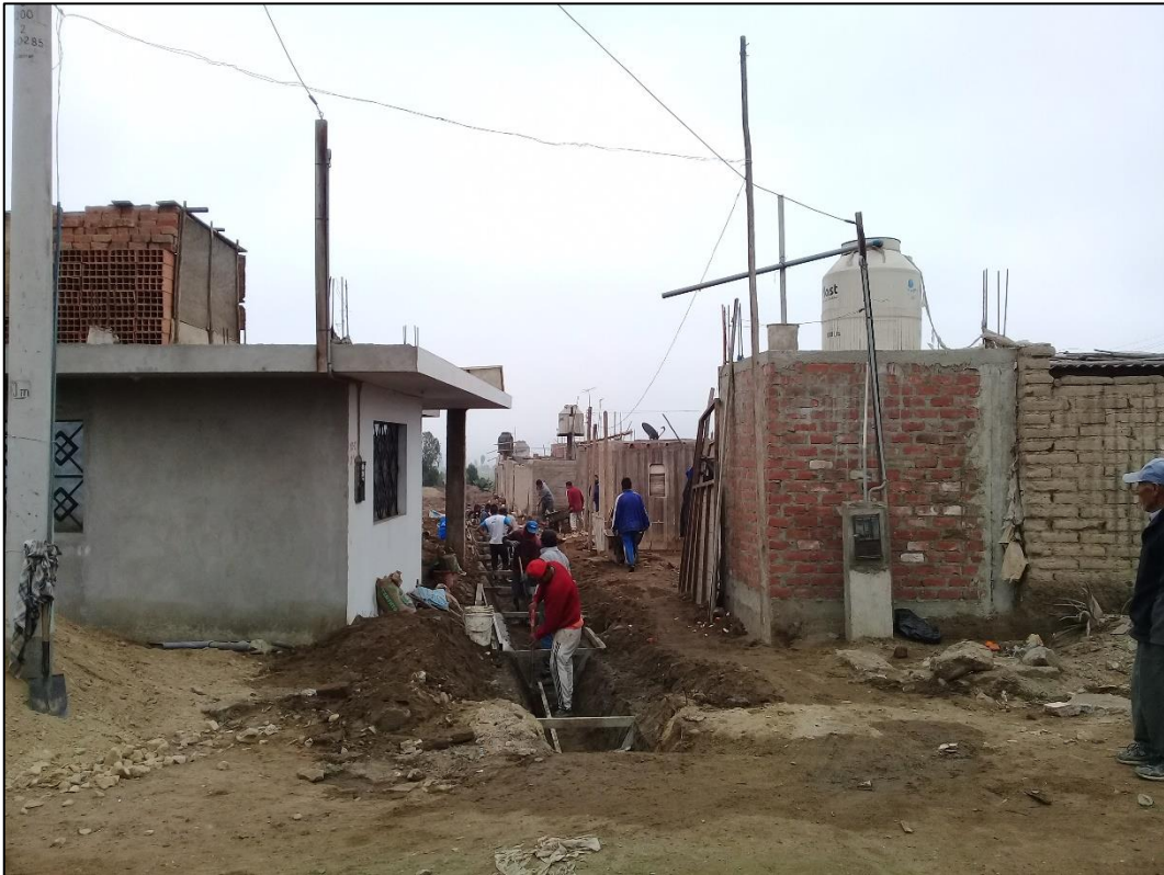
Fotografía 1. Tres operarios perfilando las paredes del canal, cinco operarios esperando y tres peones trasladando concreto en carretilla.
