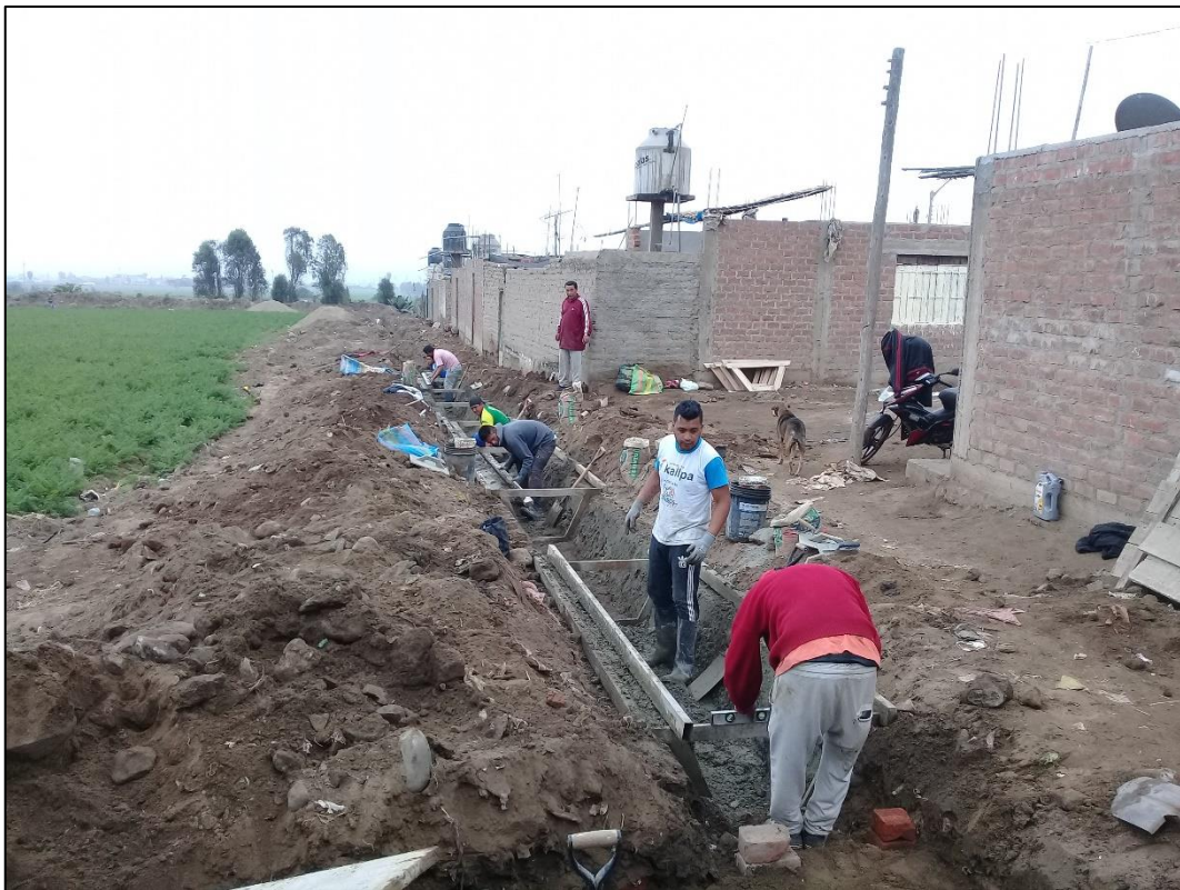
Fotografía 4. El maestro de obra inspeccionando el nivel horizontal de la cercha, cuatro operarios realizando el regleado, un operario mirando y un peón parado.
