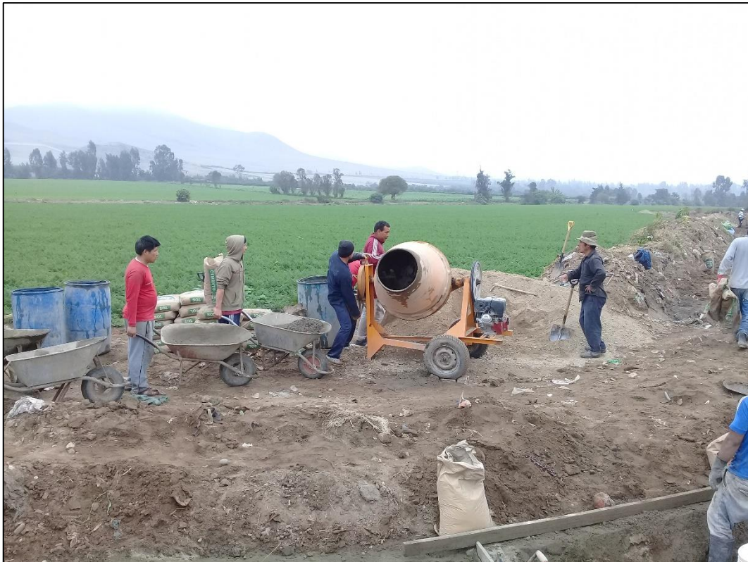
Fotografía 13. Un oficial preparando concreto, un peón trasladando concreto en carretilla y tres peones esperando.
