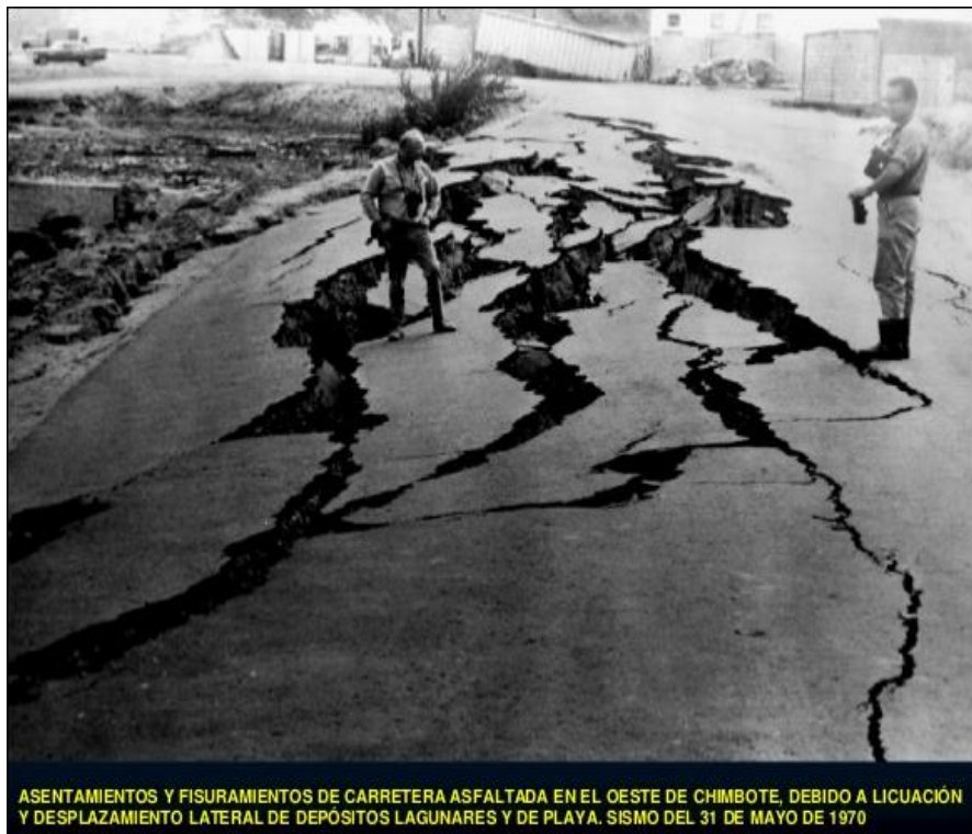
Imagen 030: Pistas fisuradas producto del terremoto Fuente: www.diariodechimbote.com
