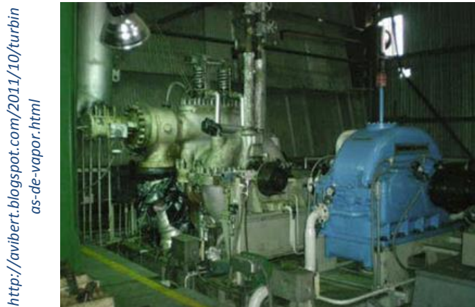
Turbina de vapor
