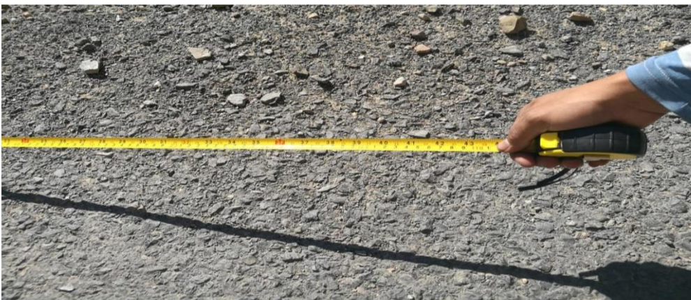
Foto 03: Desprendimiento es el desgaste del pavimento por la pérdida del ligante asfáltico
