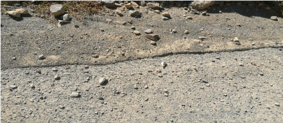
Foto 02: Grietas de borde, este daño suele originarse debido a condiciones climáticas
