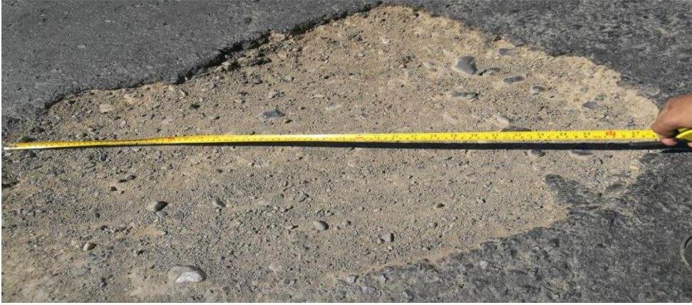
Foto 01: Hueco, son depresiones en la superficie del pavimento
