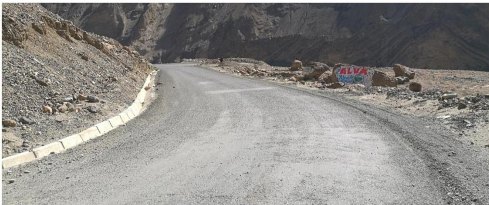
Foto 02: Cunetas existentes y parcialmente obstruido
