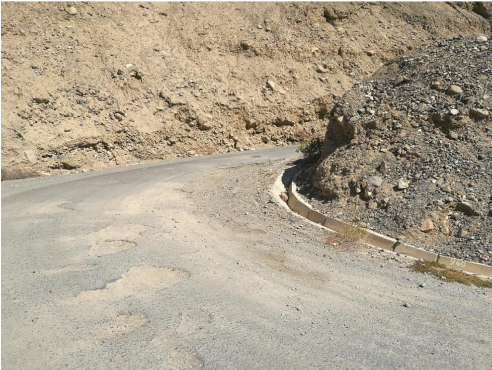
Foto 02: Señalización inexistente en toda la longitud de la carretera
