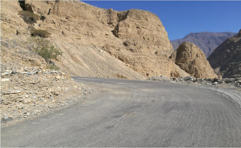
Foto 01: Señalización inexistente en toda la longitud de la carretera
