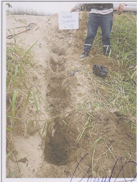
Foto N°04: Ubicación de la calicata C-02. De 0.00 a 2.00m de profundidad presencia de arena mal graduada, con raíces, materia orgánica y bloques de roca. De 2.00m a 3.00m de profundidad, presencia de arenas mal graduada (SP), suelta, húmeda a saturado de color beige claro a beige oscuro. El nivel freático se registró a los 2.20m de profundidad.
