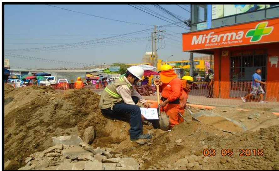
Fotografía N° 02: Vista del colector ampliación Bayovar, recolección de muestra N°2.
