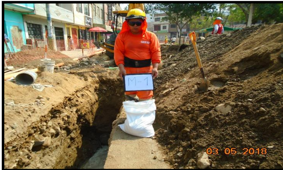
Fotografía N° 01: Vista del colector ampliación Bayovar, recolección de muestra N°1.
