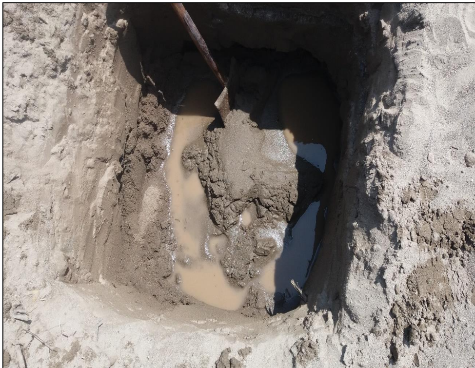
Figura 25. Presencia de nivel freático en la excavación de calicata N° 07.
