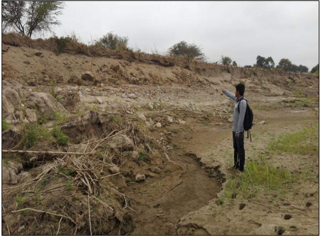
Figura 5. Presencia de erosión lateral del río Reque.
