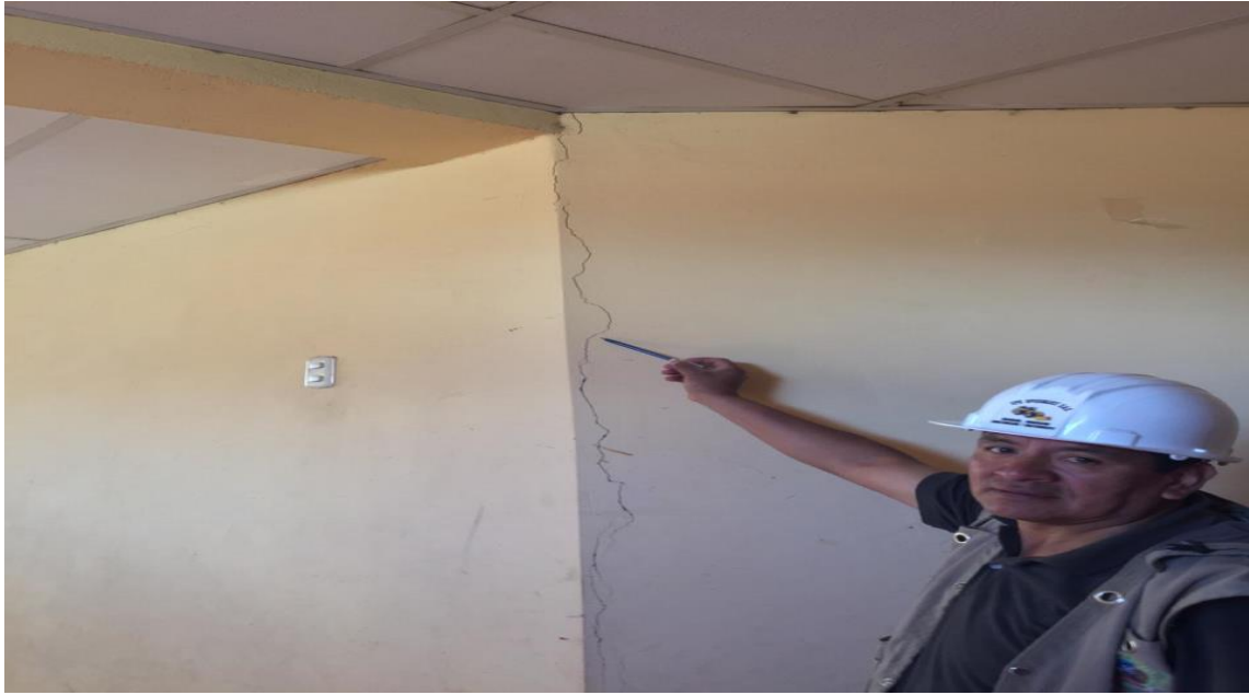
Figura 109 Fisura por confinamiento viga-columna
