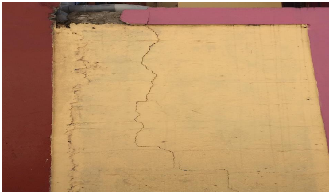
Figura 108 Fisura por falta de reforzamiento ante montante sanitaria
