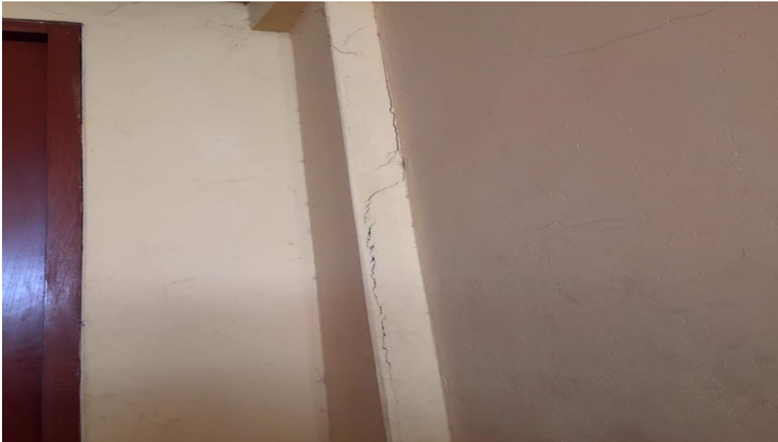
Figura 107 Fisura por falta de resistencia de elemento vertical
