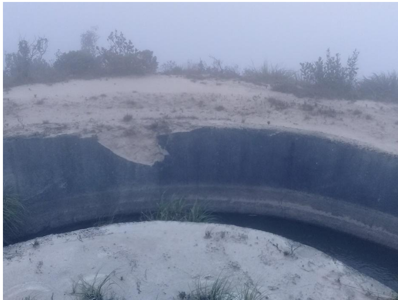
Figura 26. Estructura del canal roto.
