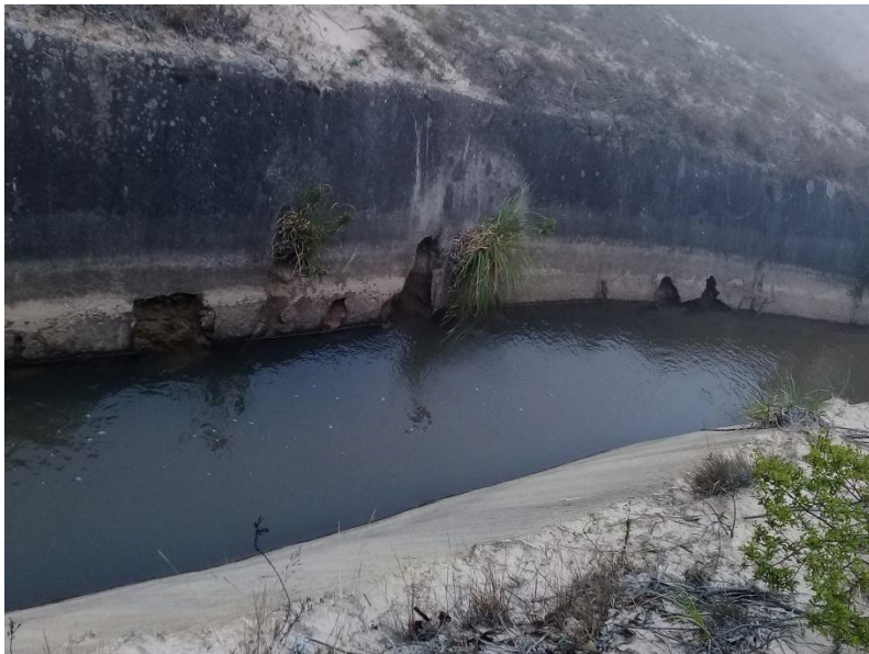
Figura 28. Canal con huecos en su estructura
